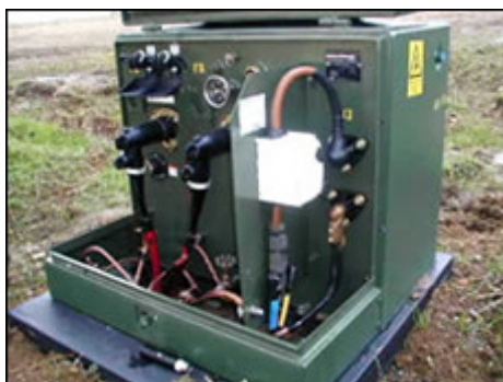
Figura 4.1. Transformador de distribución eléctrica.
