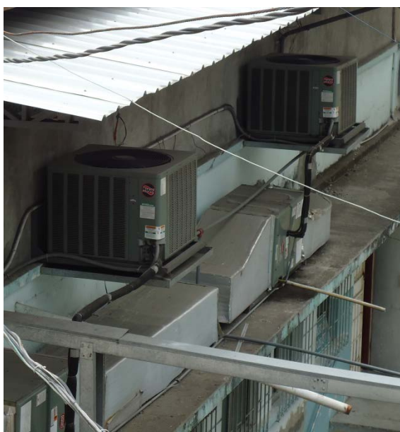
Figura 4.2. Unidades de climatización.
