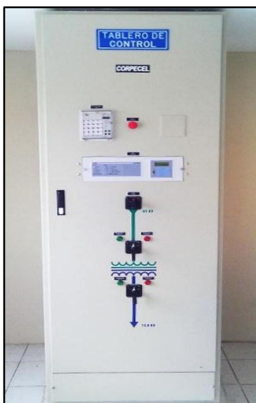
Figura 1-11 Tablero de Control.
