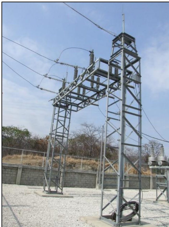
Figura 1-4 Estructuras a Nivel de 69 KV.
