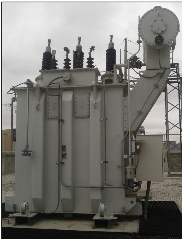
Figura 1-7 Transformador de Potencia 10 / 12,5 MVA - ABB
