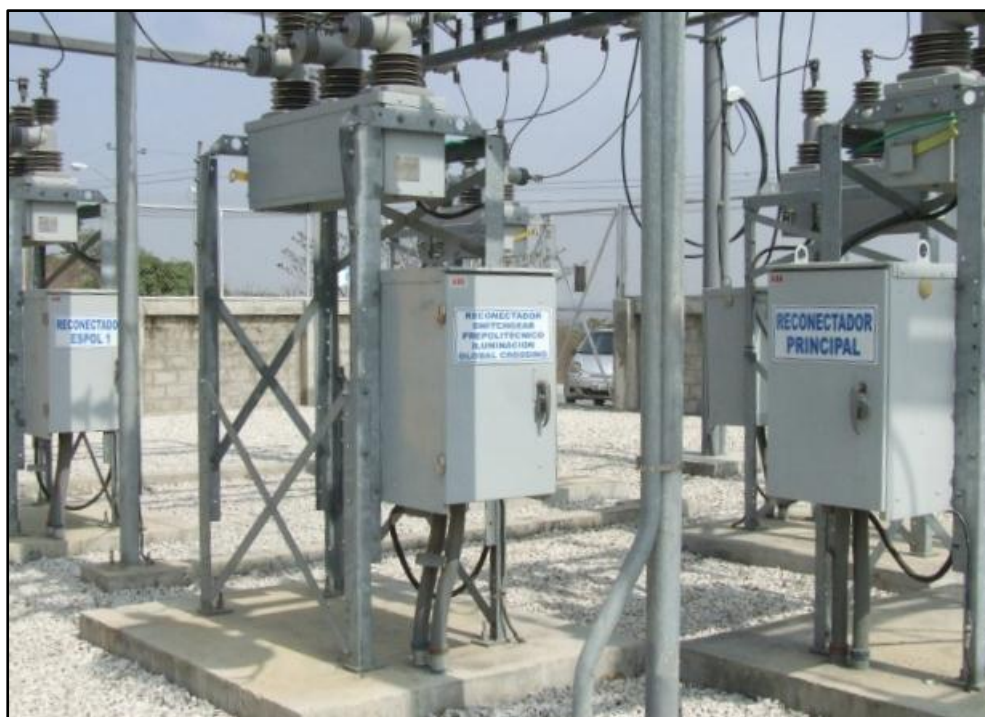
Figura 1-10 Reconectores instalados en la Subestación ESPOL.
