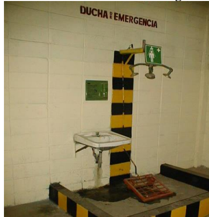
Ilustración 24. Duchas de emergencias
