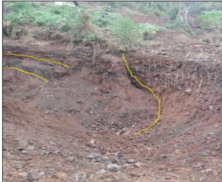
Imagen 3.1.- Afloramiento constituido de material altamente meteorizado con material arcilloso (Autores, 2018)
