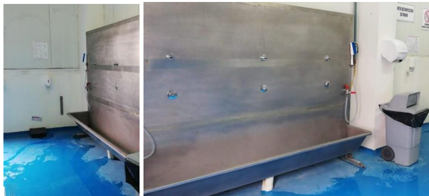
Figura 2.14 Estación de higienes y desinfección
