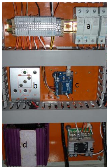
Fig. 3.13. Parte interna del tablero de control del Panel Fotovoltaico.
