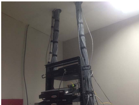
Figura 3.6 Cielo falso / rack de comunicaciones
