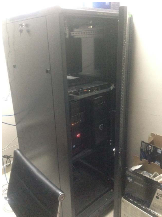
Figura 3.3 Rack de 19" donde se encuentra ubicado físicamente el servidor GIS
