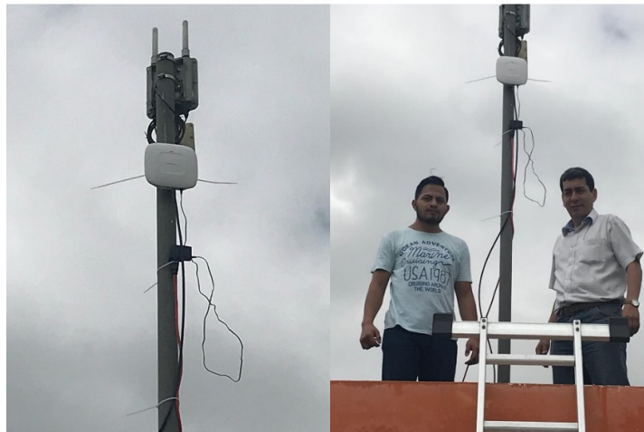
Figura 38 – Instalación de RadioMesh Gateway en el Centro Integral de Equinoterapia
