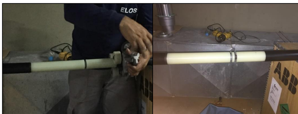
Figura 3.44 Desprendimiento de capa de aislamiento con ayuda de herramienta.
