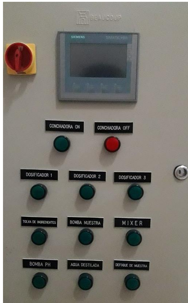
Figura Anexos A3. 1 Panel de control con luces piloto y HMI
