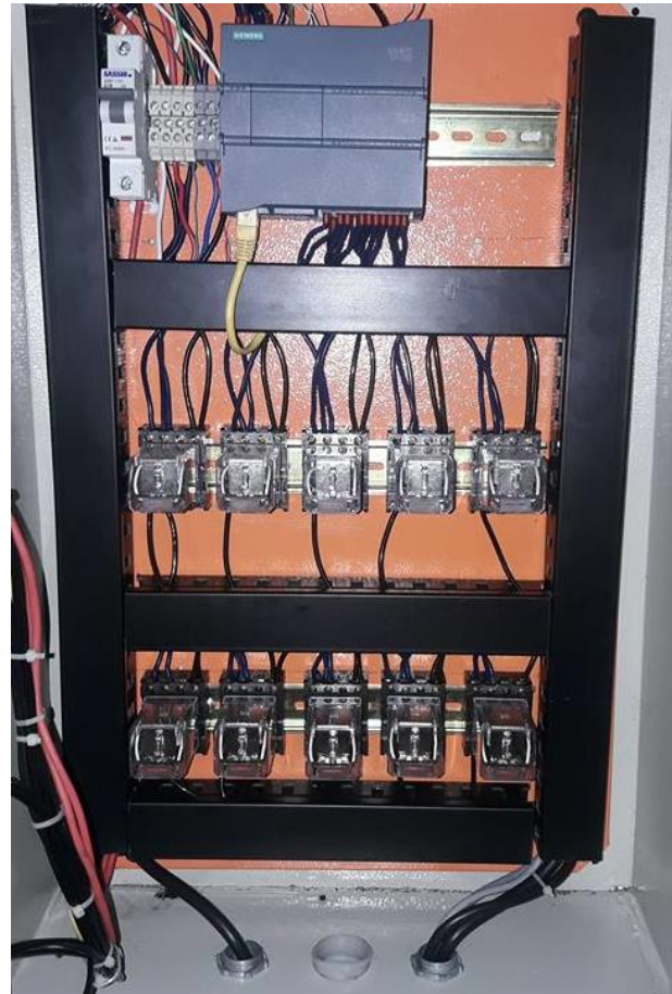
Figura Anexos A3. 2 Conexiones internas de tablero de control.
