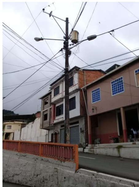
Figura 2.6. Fotografía de luminarias instaladas en poste de hormigón en la intersección de las calles 10 de Agosto y 25 de Diciembre de Paccha
