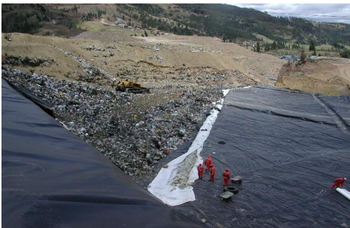
Drenes de recolección de lixiviados
