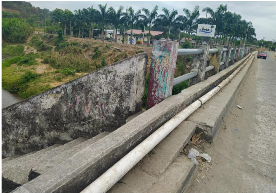
Figura 1.7 Tramo de línea de impulsión de PVC
