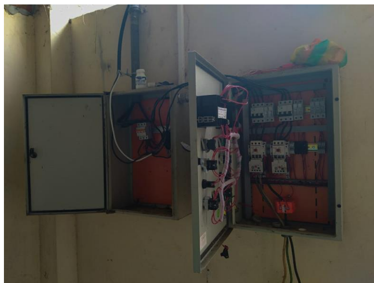
Figura 1.4 Tablero de control de estación de bombeo principal
