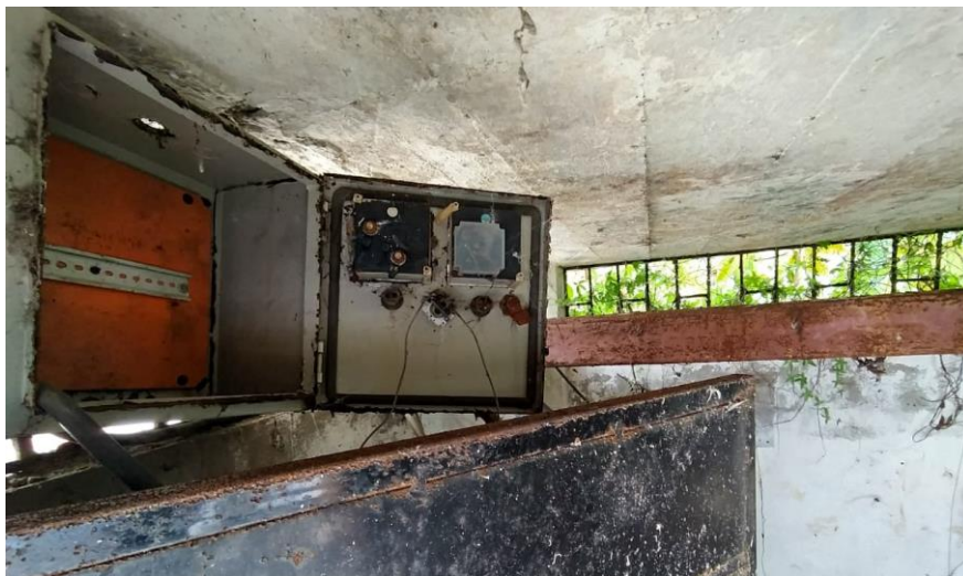
Figura 1.6 Tablero de control de estación de bombeo secundario
