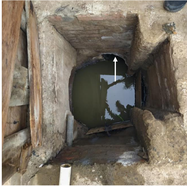
Figura 1.5 Tubería de descarga hacia Río Mosca en cámara receptora
