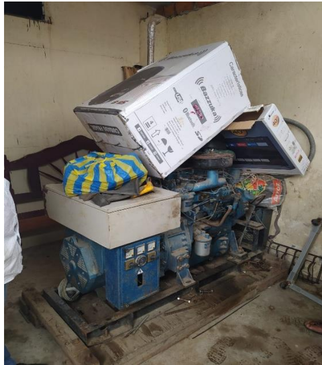
Figura 1.3 Estado actual del generador eléctrico de estación de bombeo principal
