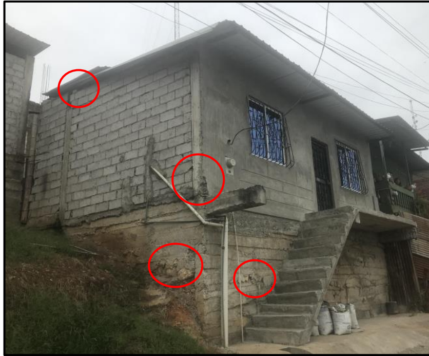
Figura 2.12 Vivienda inspeccionada deficiencias señaladas [González & Loja, 2019]
