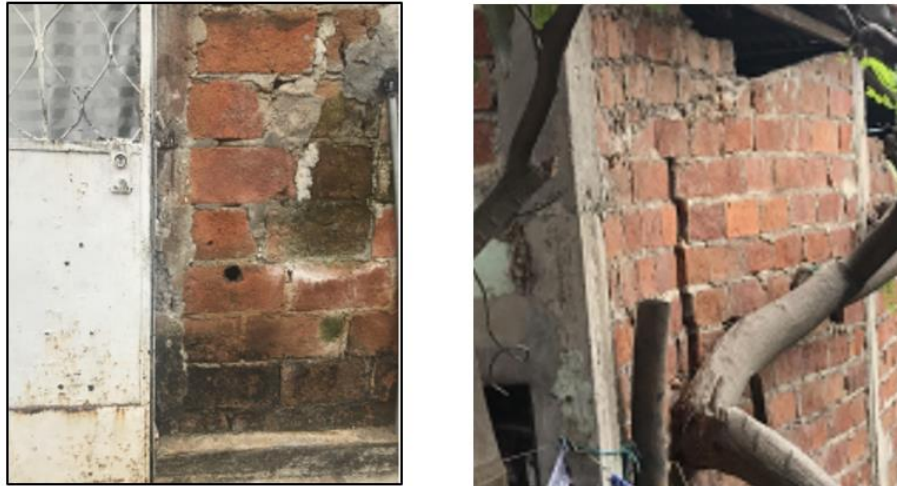
Figura 3.5 Fisuras, huecos y grietas en paredes de ladrillo [González & Loja, 2019]
