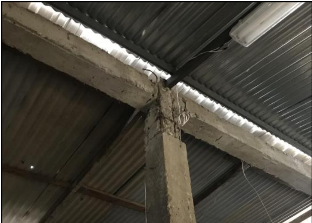
Figura 3.2 Vivienda de dos pisos de hormigón con inadecuada conexión entre la columna y la viga con segregación y varillas expuestas. [González & Loja, 2019]
