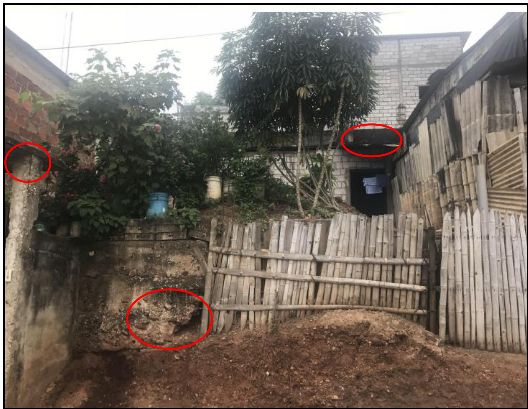
Figura 2.13 Vivienda con muro de contención dañado en la base de la estructura [González & Loja, 2019]
