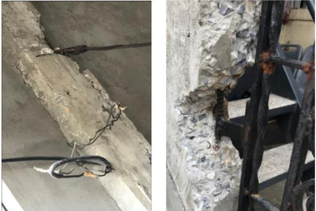
Figura 3.3 Remoción intencional de hormigón en elementos estructurales inadecuada conexión con otras estructuras [González & Loja, 2019]
