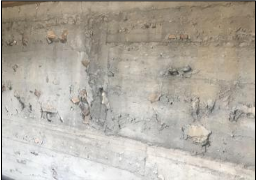
Figura 3.7 Cavidades en muros de contención de hormigón ciclópeo en el sector de Bastión Popular [González & Loja, 2019]
