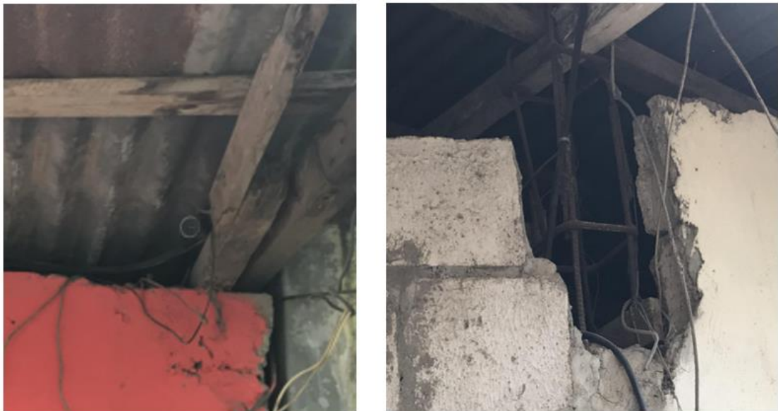
Figura 3.8 Inadecuadas conexiones en apoyos de cubierta de estructura de madera. [González & Loja, 2019]
