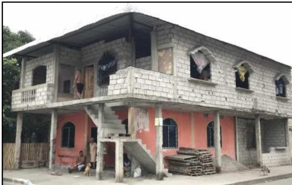
Figura 2.21 Viviendas de dos pisos con inadecuadas ampliaciones [González & Loja, 2019]
