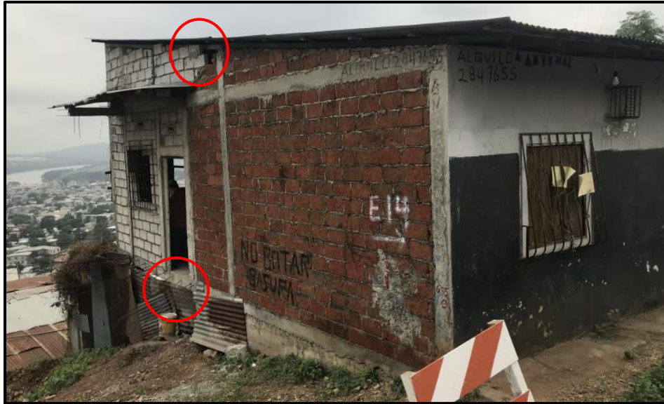
Figura 2.9 Vivienda inspeccionada deficiencias señaladas [González & Loja, 2019]
