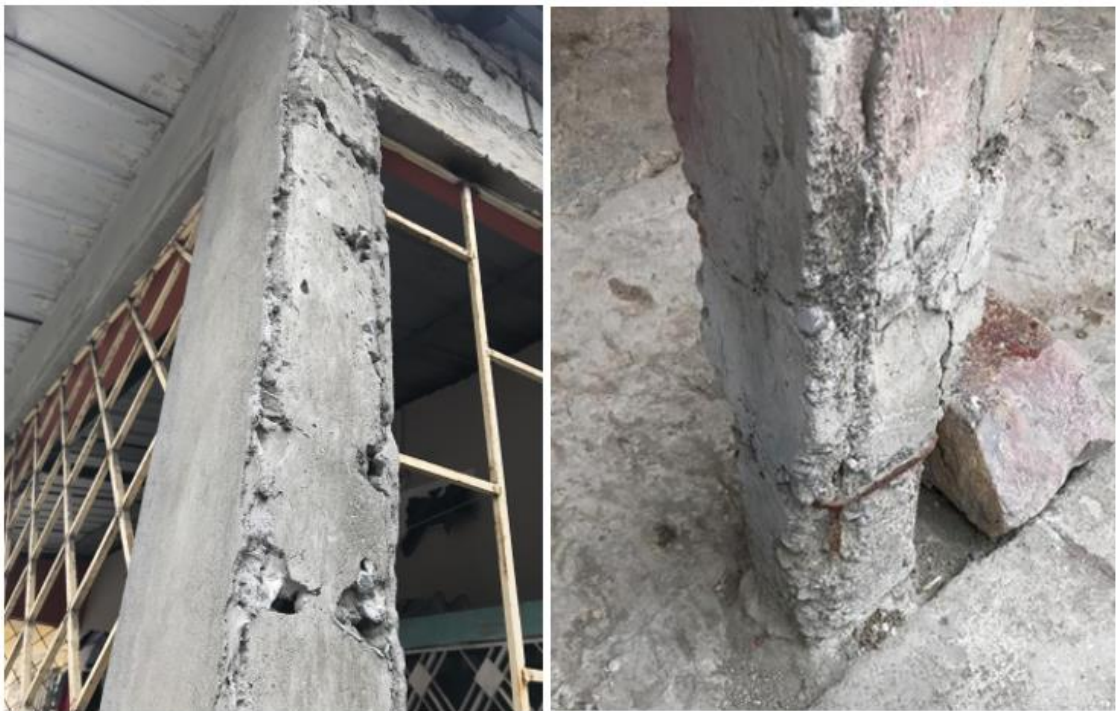
Figura 3.4 Columnas con falta de recubrimiento y varillas de refuerzo expuestas [González & Loja, 2019]
