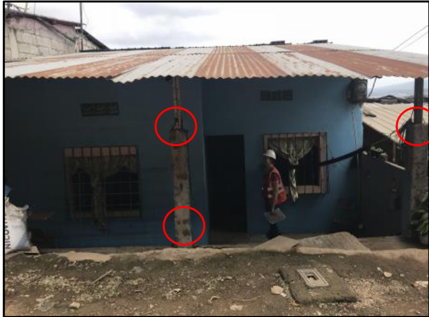
Figura 2.7 Vivienda de hormigón 2 pisos deficiencias señaladas [González & Loja, 2019]
