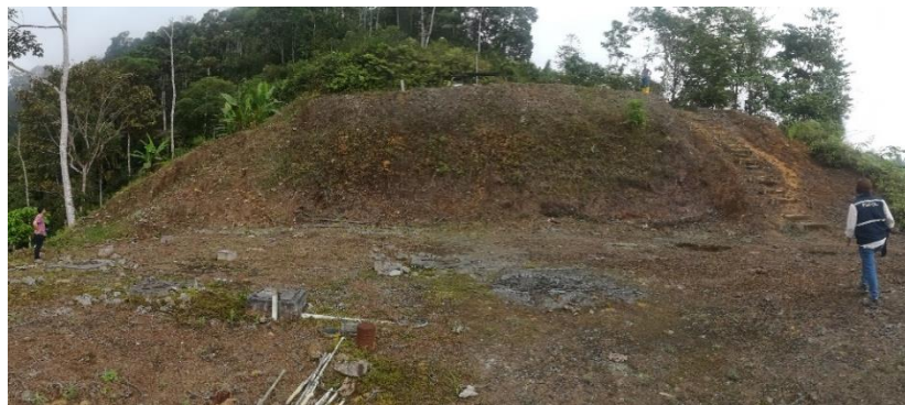
Figura 1.2 Terraza intermedia donde se evidencia asentamiento
