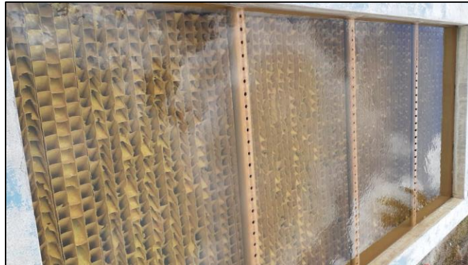
Figura 2.12 Rejilla del sedimentador
