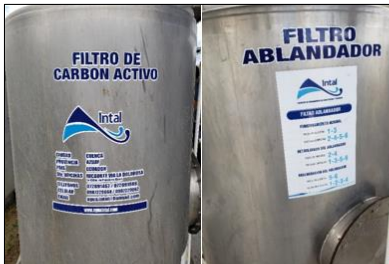
Figura 2.14 Filtros de carbono y ablandamiento
