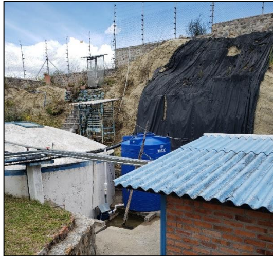
Figura 2.15 Tanque de almacenamiento y cloración
