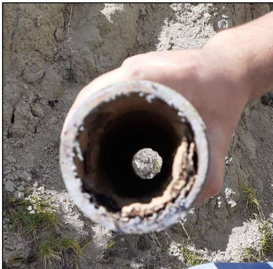
Figura 2.18 Presencia de costras en las superficies de las tuberías
