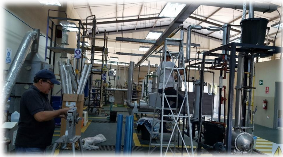
Figura 76. Aislado la línea de vapor que se conectan a nuestro equipo. Fuente: (Pactong, Solange; Salinas, Marcelo.)
