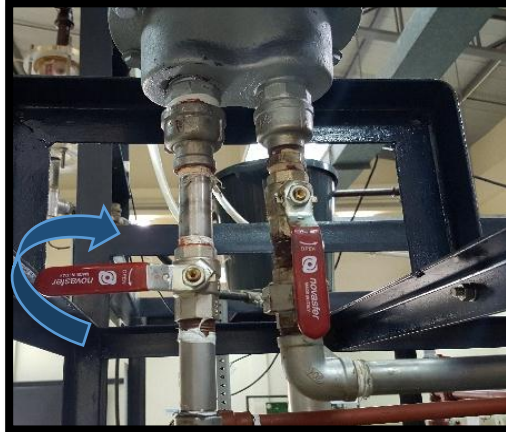
Figura 38. Válvulas que permiten el ingreso y salida del intercambiador.
