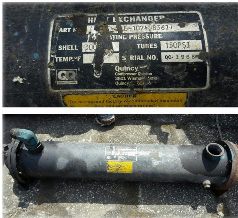
Figura 64. Súper Heat antes del mantenimiento.
