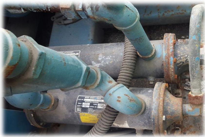
Figura 63. Intercambiadores de calor antes de darle mantenimiento.
