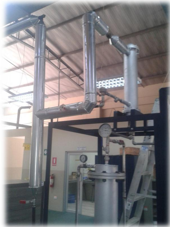
Figura 26. Líneas de vapor aisladas térmicamente.
