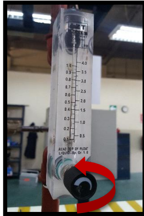
Figura 45. Controlador de flujo.
