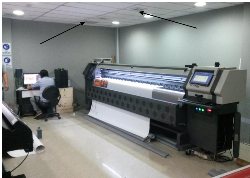
IMAGEN 4.1: VENTILACIÓN Y EXTRACCIÓN DE AIRE
