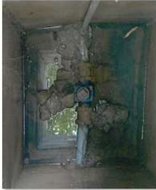
Figura 2.16. Válvula desviada con presencia de sedimentos. [Obtenido de: Catastro red AAPP ESPOL]
