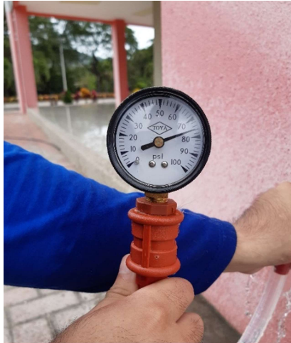
Figura 2.18. Toma de presión a las afueras del edificio de UBEP [López & Zambrano, 2021].
