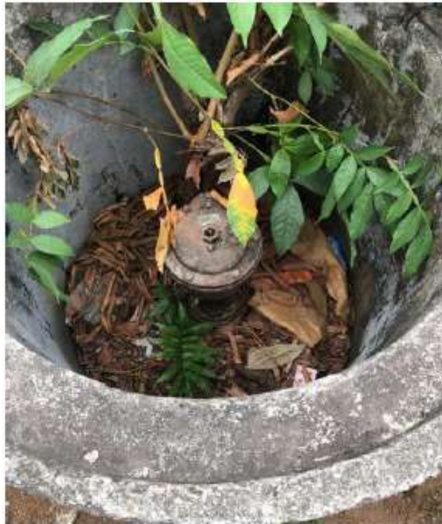
Figura 2.13. Cámara de inspección cubierta de sedimentos. [Obtenido de: Catastro red AAPP ESPOL]
