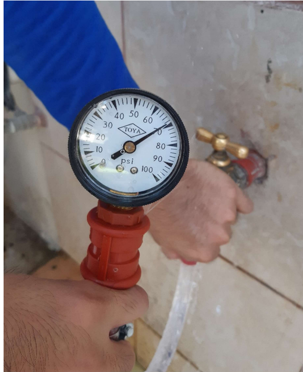
Figura 2.11. Uso de manómetro para medir presiones en edificaciones de la ESPOL [López & Zambrano, 2021].
