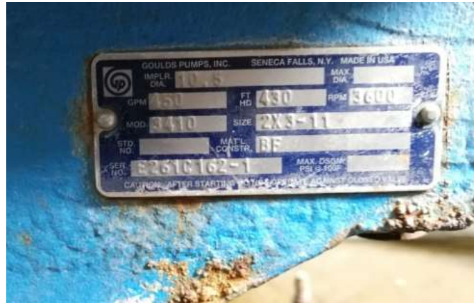
Figura 2.5. Placa de una de las bombas del sistema de agua potable de la ESPOL. [Obtenido de: GIF ESPOL]
