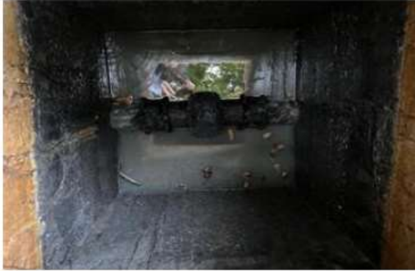
Figura 2.14. Falta de mantenimiento en válvulas. [Obtenido de: Catastro red AAPP ESPOL]
