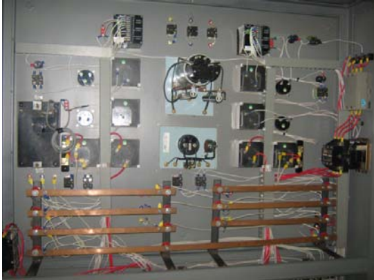
Figura 2. Ubicación y conexión de equipos parte trasera.
