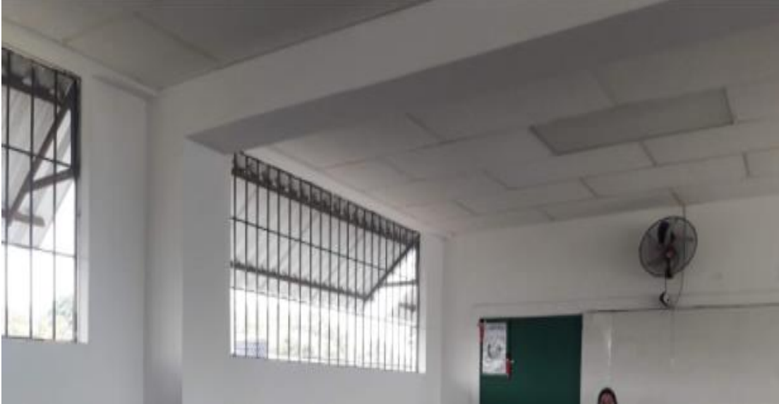
Ventilación y Luminaria Instaladas en Cursos
