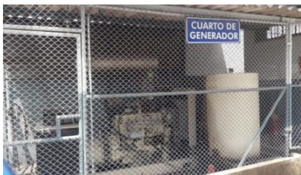
Figura 3.2 Cuarto de Generador
