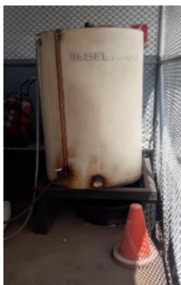
Figura 3.3 Tanque de Almacenamiento de diésel
