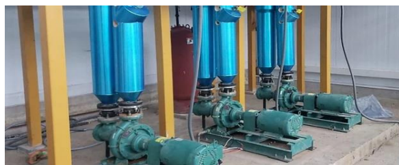
Figura 1.5 Bombas hidráulicas para agua helada (Fuente: Mechanical Projects S.A.)
