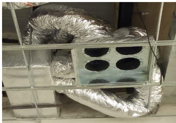
Figura 1.8 Ducto flexible con aislamiento (Fuente: Elaboración propia)
