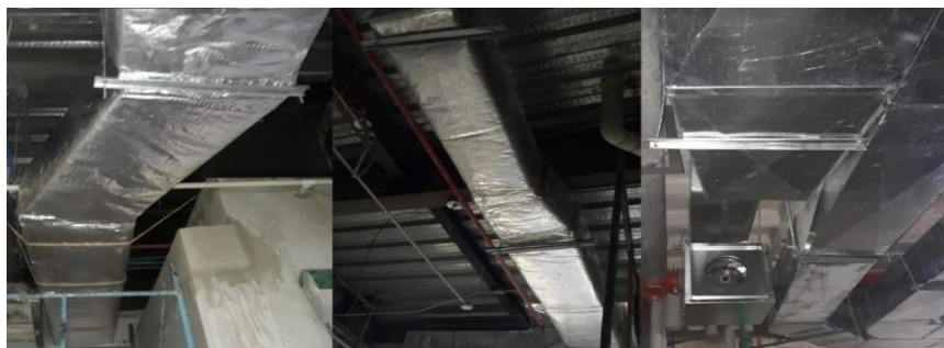
Figura 1.6 Ductos rectangulares para flujo de aire (Fuente: Elaboración propia)
