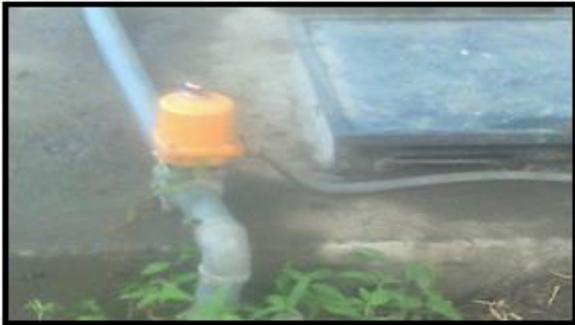
Actuador en la estación de bombeo
