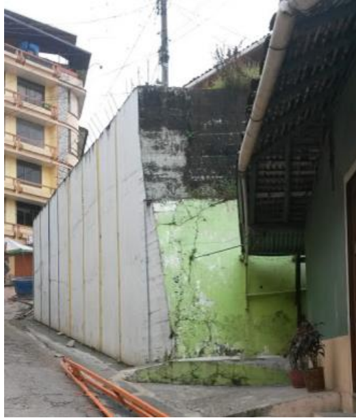
Figura 3. 5 Resquebrajamiento en una pared producto de eventos de movimientos en la zona. Fuente: Campoverde , C., 2017.
