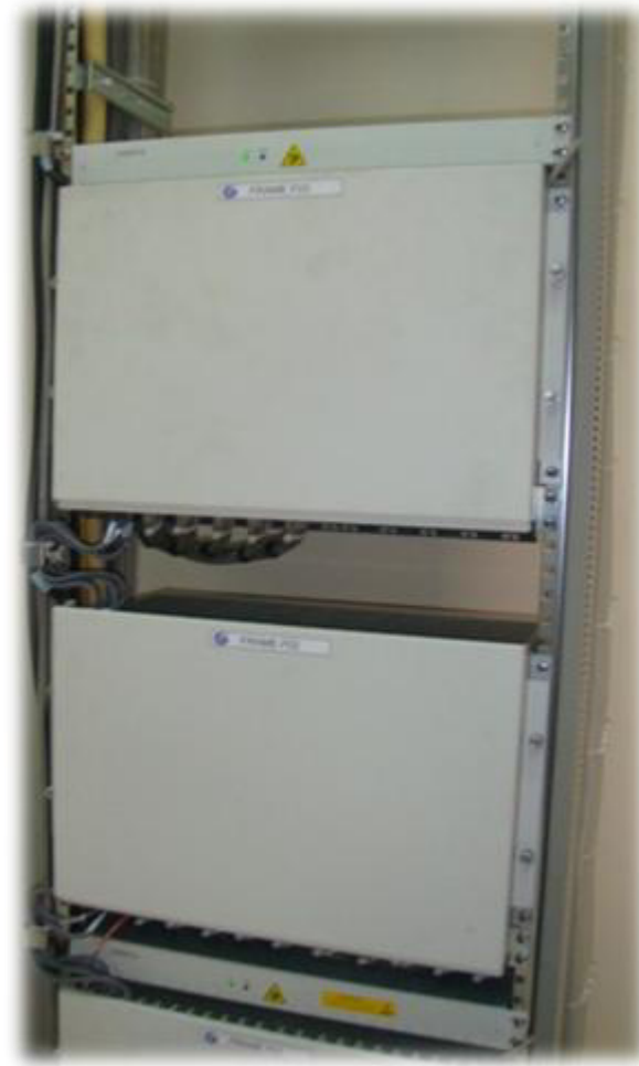
Figura 4.2 Central de conmutación Canal de Voz
