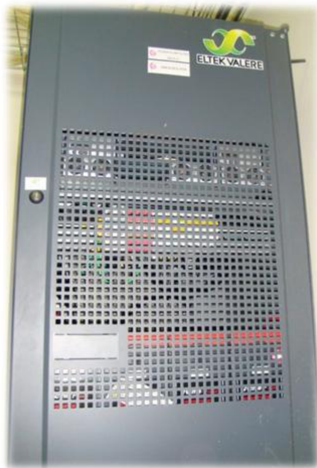
Figura 4.6 Regulador de Voltaje
