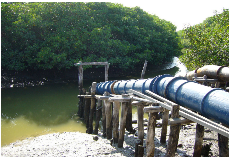
Toma de agua de los esteros
