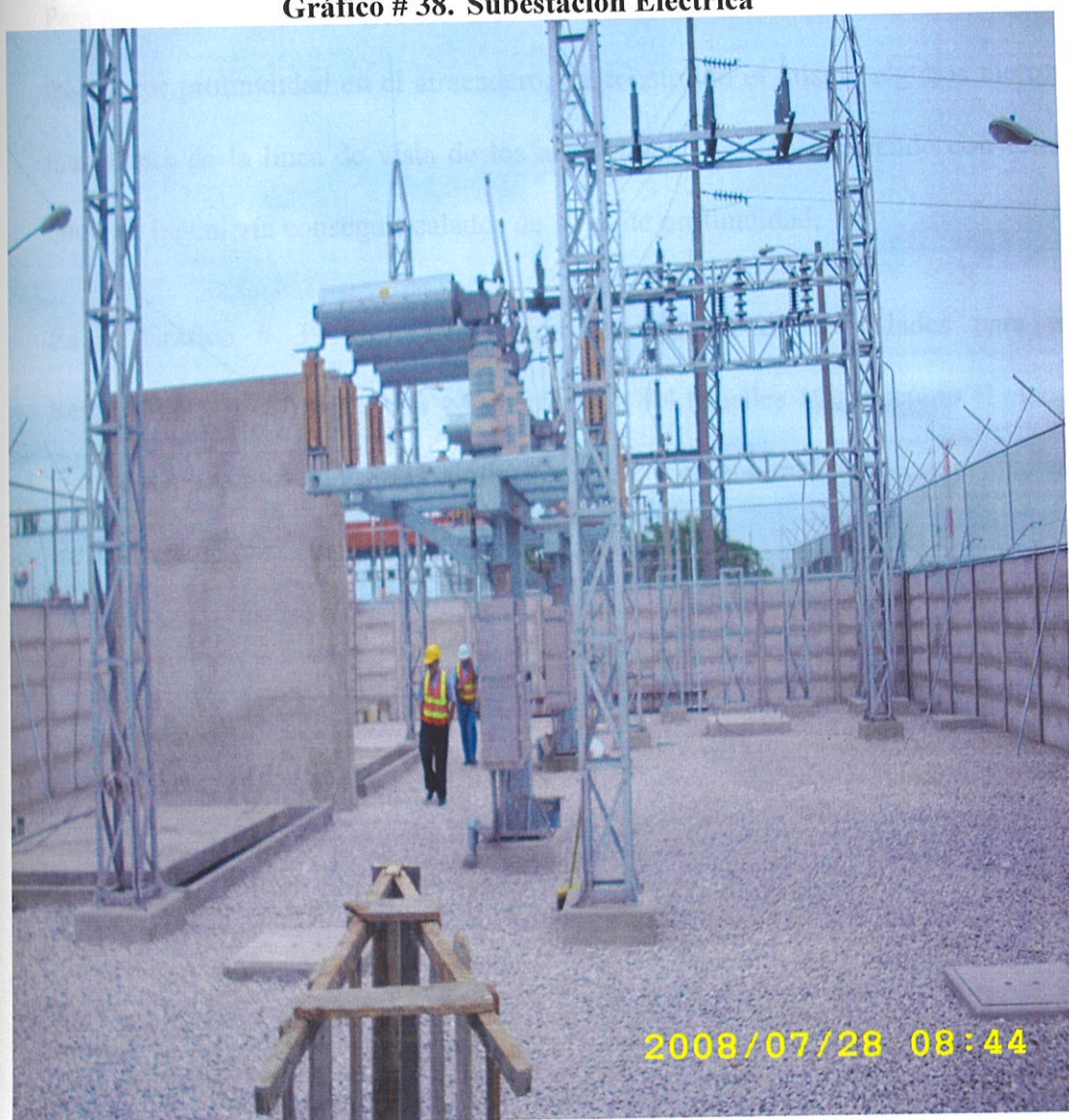
Gráfico # 38. Subestación Eléctrica
