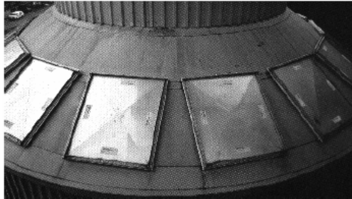
FIGURA 4.6. PANELES DEBILES DE VENTEO
