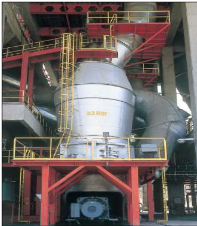
FIGURA 2.5. MOLINO DE RODILLOS EN INSTALACIÓN [5].
