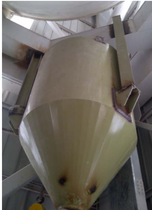
FIGURA 5.14 - SILO INSTALADO CON SU SOPORTERÍA.
