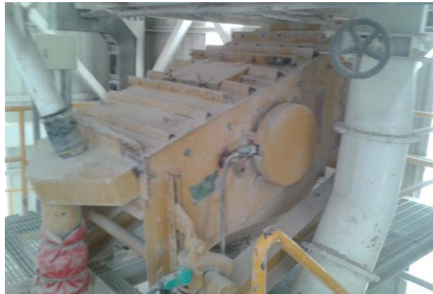
FIGURA 5.10 - EQUIPO VIBRATORIO CRIBA FINALIZADA
