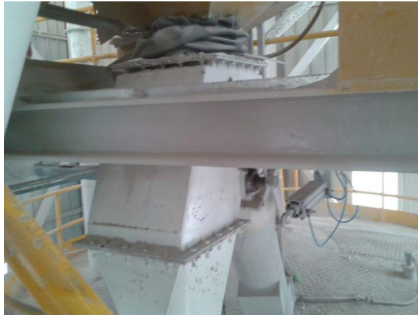
FIGURA 5.5 - VÁLVULA DE DOS VÍAS INSTALADA
