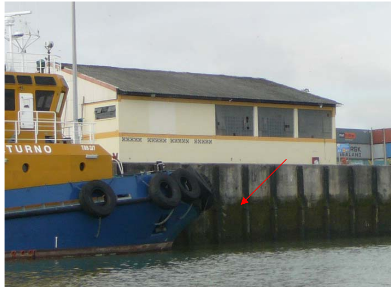
FIGURA 2.4: DEFENSAS EN MUELLE DE SERVICIOS
