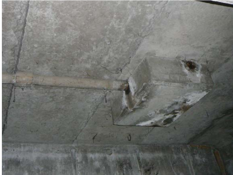
FIGURA 2.6: CAJAS DE CONEXIÓN DEBAJO DE LOSA PARA EL CABLEADO DEL SISTEMA DE PROTECCIÓN CATÓDICA
