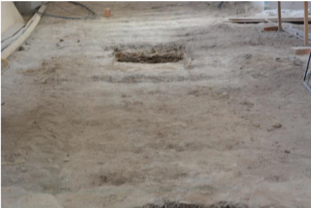
Figura 36 Ondulaciones en la superficie del área de estudio, estrato inmediato al concreto. Al parecer producidas por compactación producto de alguna técnica de construcción.
