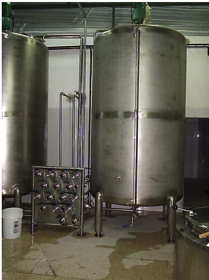
FIG. 1.6 TANQUES DE ALMACENAMIENTO DE JARABES.
