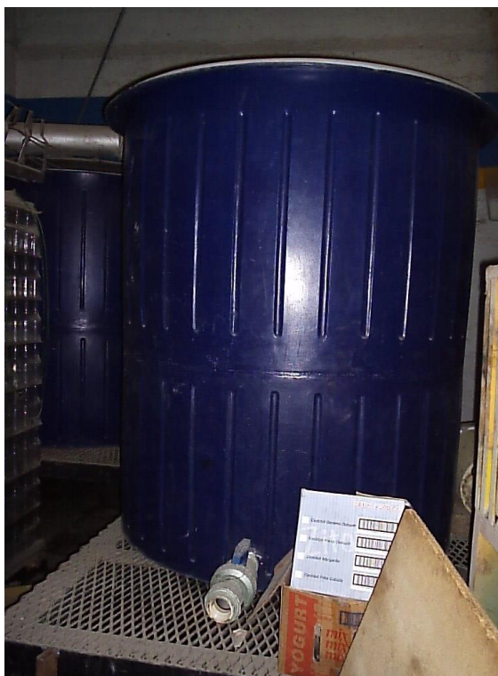
FIG. 2.2 TANQUES DE ALMACENAMIENTO DE AGUA.
