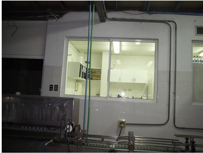
FIG. 5.5c. TUBERIA E CONECTADO A CAJA DE PASO, Y CONECTADO A CLAVIJA QUE VA A TABLERO PRINCIPAL DE ALIMENTACIÓN.
