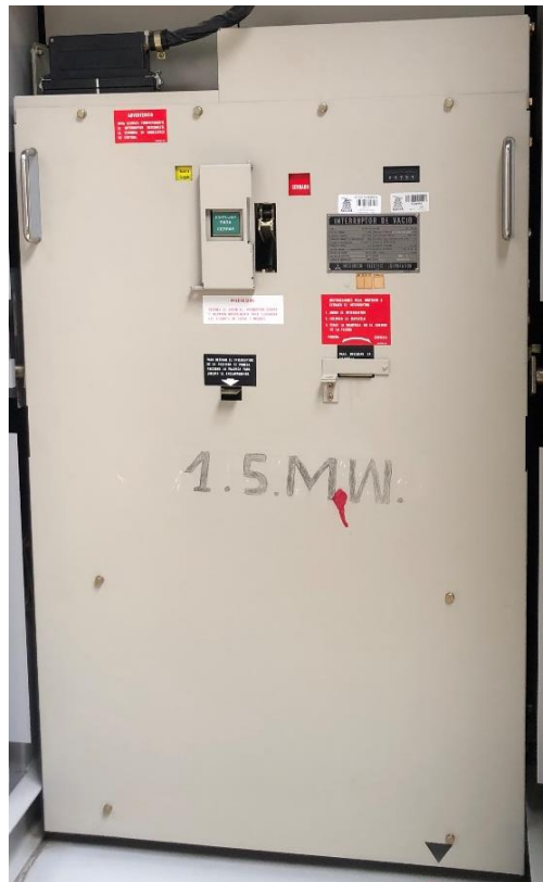
Figura 1-13: Panel frontal del interruptor en vacío Mitsubishi implementado en el panel de acoplamiento.
