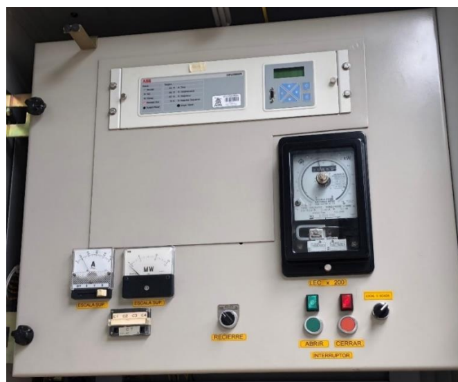
Figura 1-15: Vista frontal del panel de equipos del panel 9 de acoplamiento en la S/E San Cayetano.
