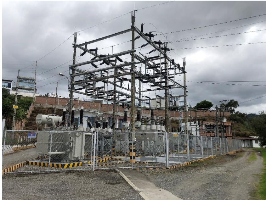
Figura 1-1: Patio de la S/E San Cayetano de la EERSSA.
