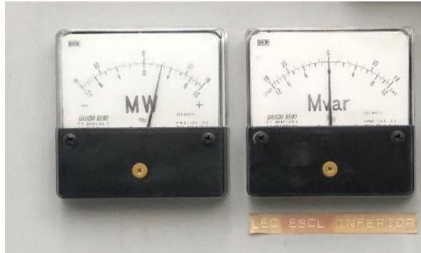
Figura 1-22: Vatímetro y varímetro colocados en la S/E San Cayetano.
