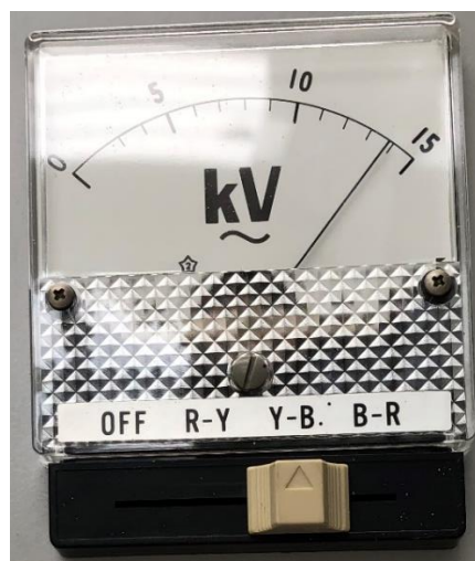
Figura 1-20: Voltímetro colocado en la S/E San Cayetano.
