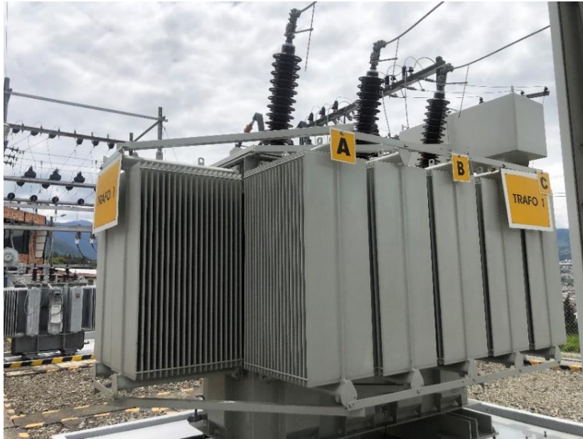
Figura 1-4: Transformador 1 en la S/E San Cayetano.
