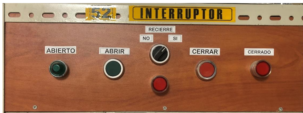
Figura 1-28: Interruptor de prueba usado en el laboratorio de la EERSSA.
