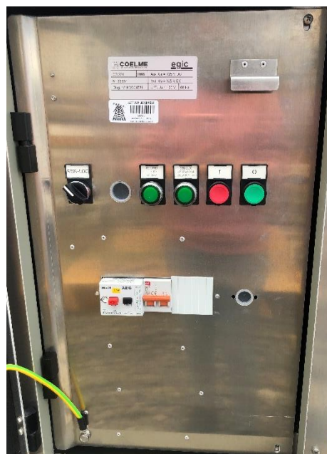
Figura 1-10: Tablero de control de seccionador de barra.
