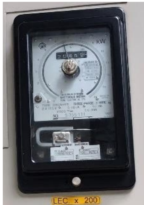
Figura 1-16: Medidor de energía implementado en varios paneles de la S/E San Cayetano.
