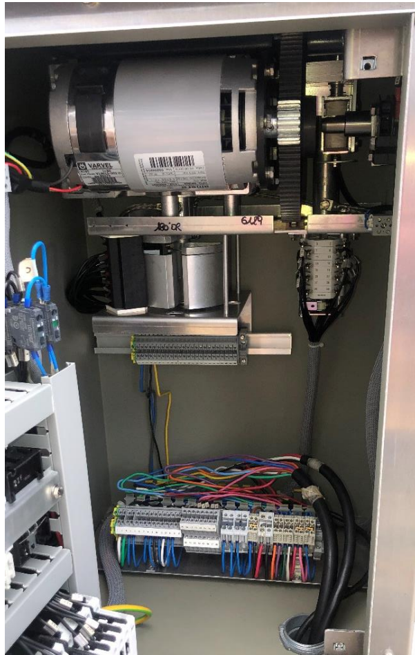
Figura 1-11: Motor, árbol de contactos y bornes auxiliares para el control del seccionador.
