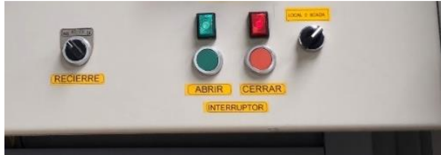
Figura 1-24: Selectores, botoneras y luces piloto para el control desde los paneles de la S/E San Cayetano.
