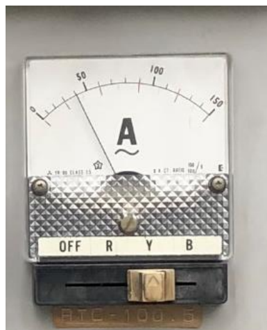
Figura 1-18: Amperímetro colocado en la S/E San Cayetano.
