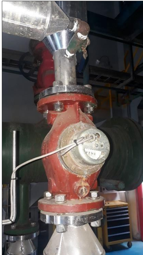
Figura 3.8 Flujómetro de agua caldera Colmaquinas
