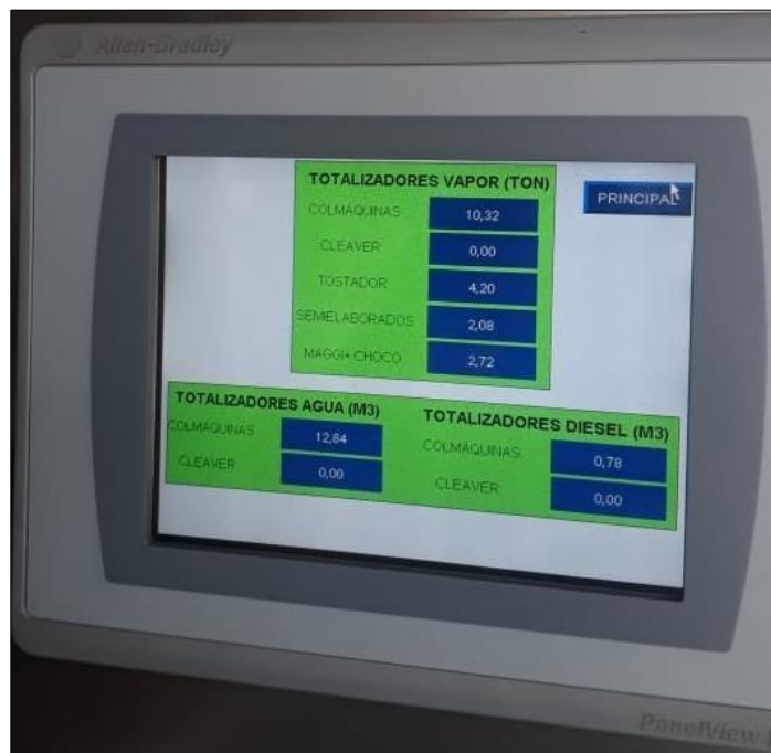
Figura 4.2 Totalizadores de vapor, agua y diésel desde HMI
