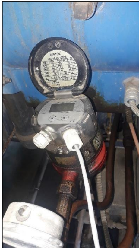
Figura 3.6 Flujómetro de diésel caldera Colmaquinas
