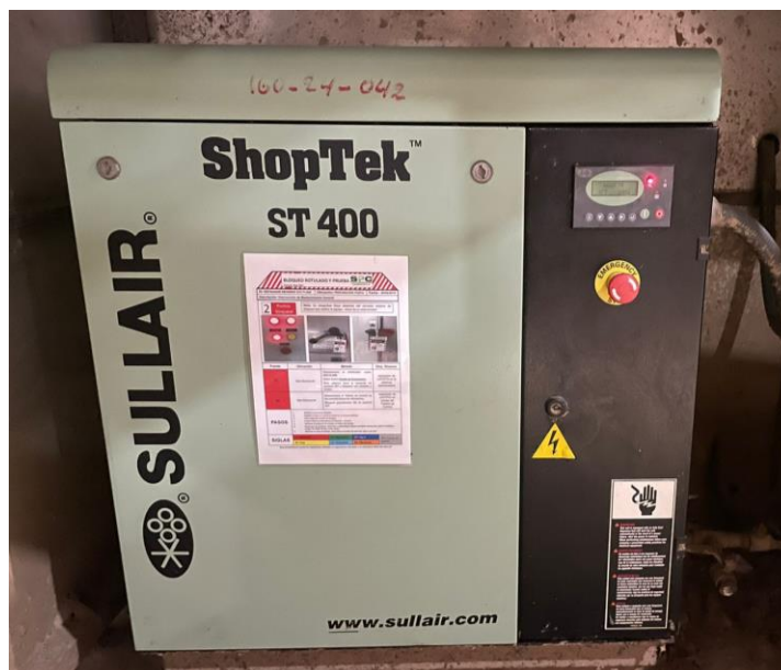
Figura 4.1 Ficha LOTO visible en máquinas y equipos
