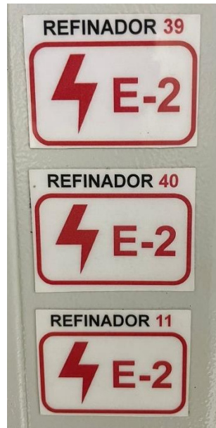
Figura 3.5 Etiqueta de identificación de fuente de energía
