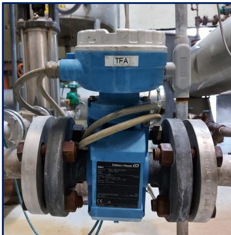
Figura 19 Transmisor de flujo marca Endress-Hauser (A2X-TFL6)
