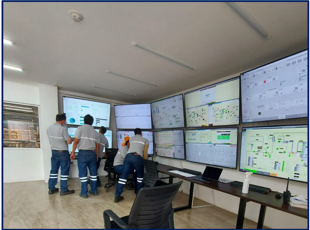
Figura 69 Oficina de supervisión y control de sistemas SCADA en SICA.
