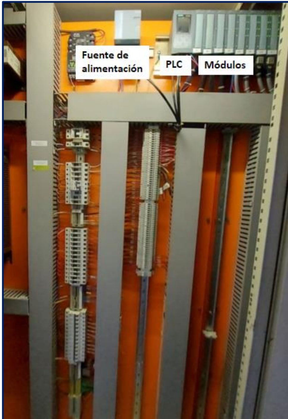
Figura 24 Panel de control perteneciente al área de extracción (A2X-PCA5)
