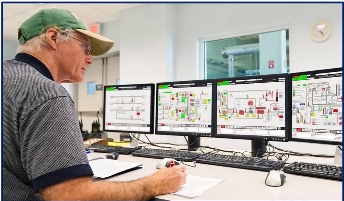
Figura 1 Centro de monitoreo industrial haciendo uso de Ignition SCADA
