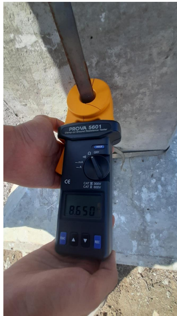
Imagen 23. Medida registrada el 17 de diciembre del año 2020 en sistema de puesta a tierra de acero inoxidable instalado en el Poste 326 de línea de transmisión vía Salinas en Santa Elena
