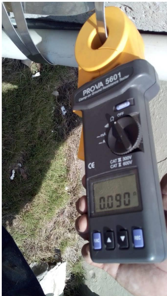
Imagen 20. Medida registrada el 8 de febrero del año 2019 en sistema de puesta a tierra de acero inoxidable instalado en la Playa Mar Bravo en la ciudad de Salinas
