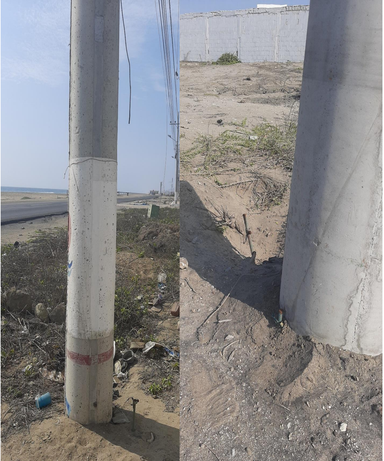
Imágenes de hurto de materiales estratégicos instalados en sitio
