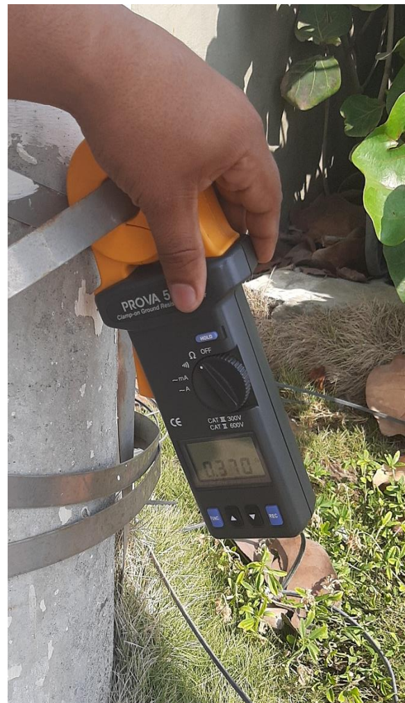
Imagen 21. Medida registrada el 17 de diciembre del año 2020 en sistema de puesta a tierra de acero inoxidable instalado en la Playa Mar Bravo en la ciudad de Salinas
