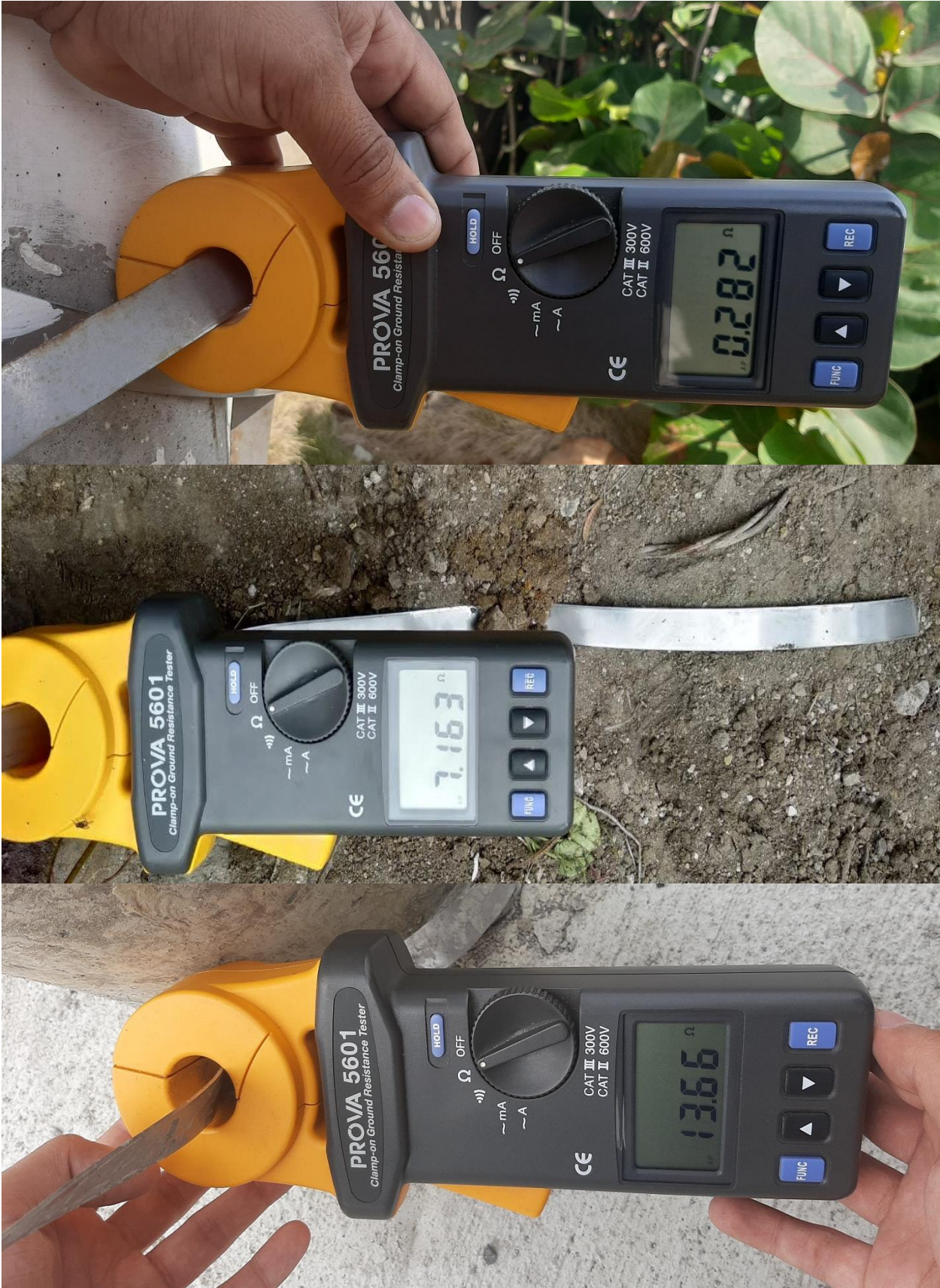
Resistencias de puesta a tierra en acero inoxidable instaladas
