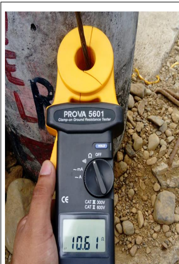
Imagen 12. Sistema de puesta a tierra convencional para un transformador en La Ventura en la ciudad de Babahoyo
