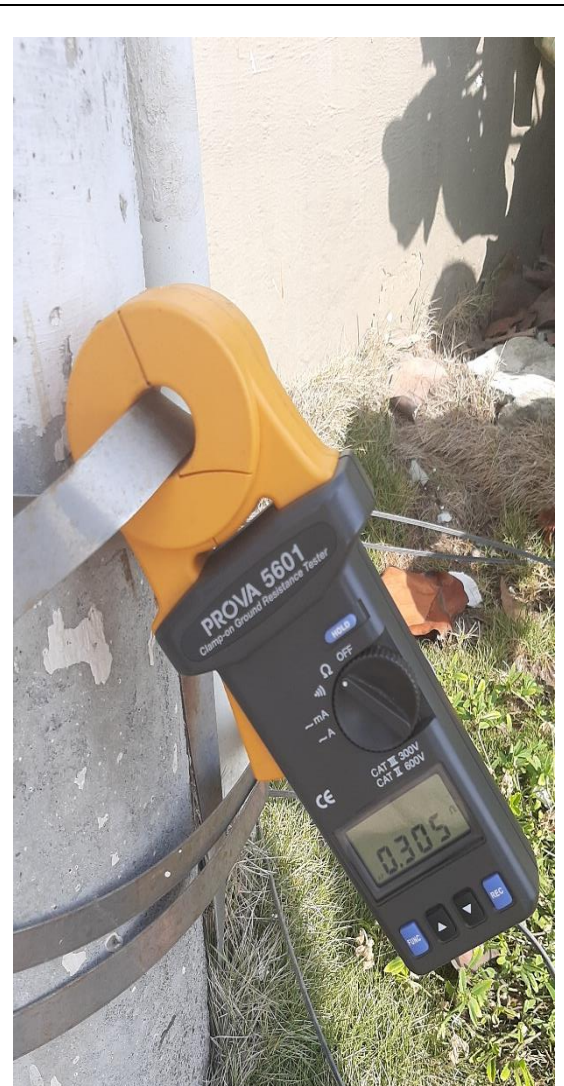
Imagen 15. Medida registrada en diciembre del 2020 en sistema de puesta a tierra de acero inoxidable instalado en la Playa Mar Bravo
