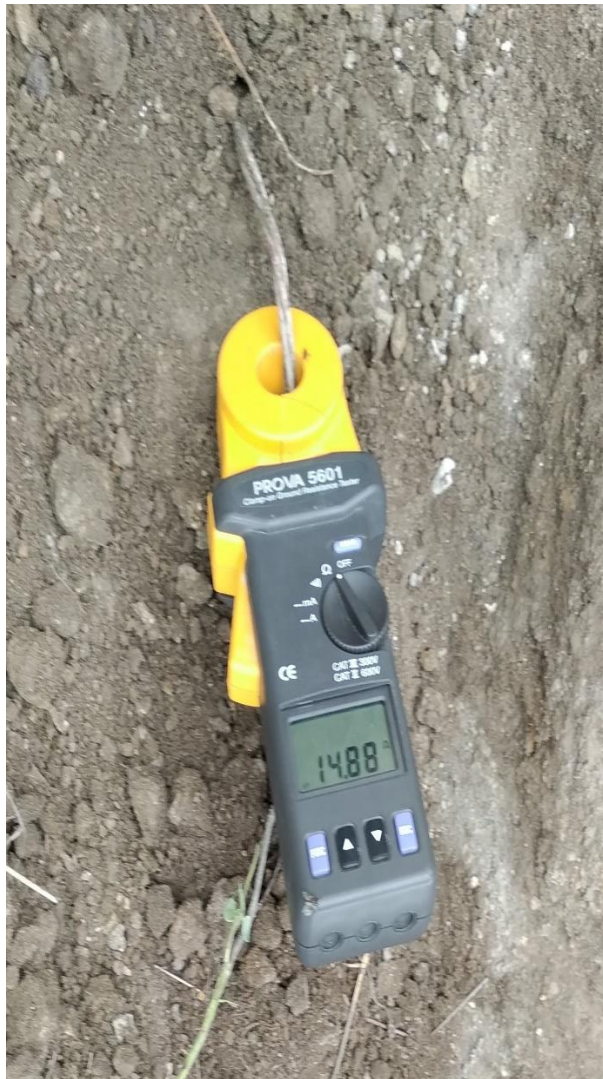
Imagen 16. Sistema de puesta a tierra convencional en cobre y copperweld para estructura en el POSTE 326 vía Salinas
