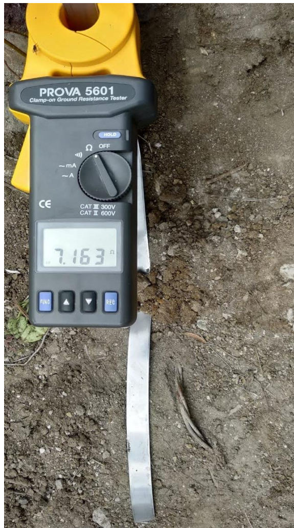
Imagen 22. Medida registrada el 19 de enero del año 2020 en sistema de puesta a tierra de acero inoxidable instalado en el Poste 326 de línea de transmisión vía Salinas en Santa Elena
