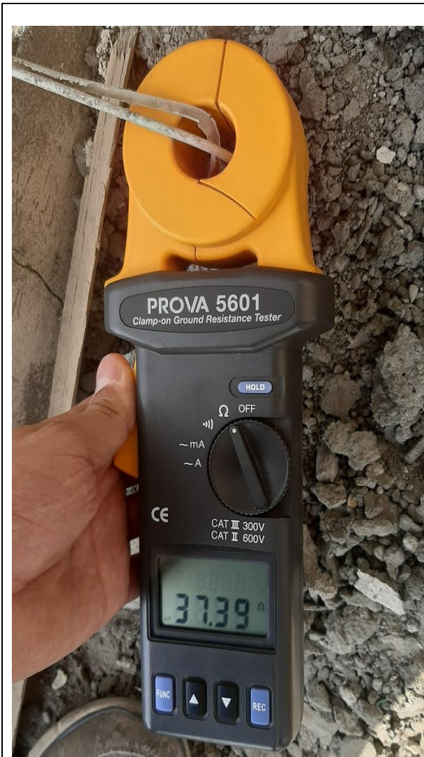
Imagen 14. Medida registrada el 09 de enero del año 2019 en sistema de puesta a tierra convencional deteriorada en la Playa Mar Bravo en la ciudad de Salinas
