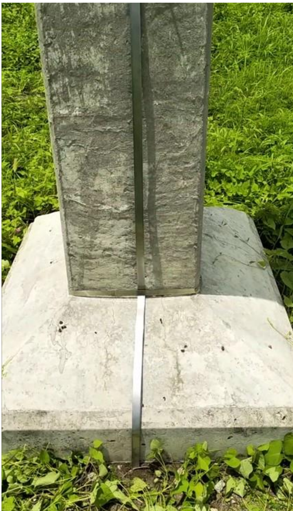
Instalación de SPT de acero inoxidable de estructura de transmisión vía Santa Elena, parte 3
