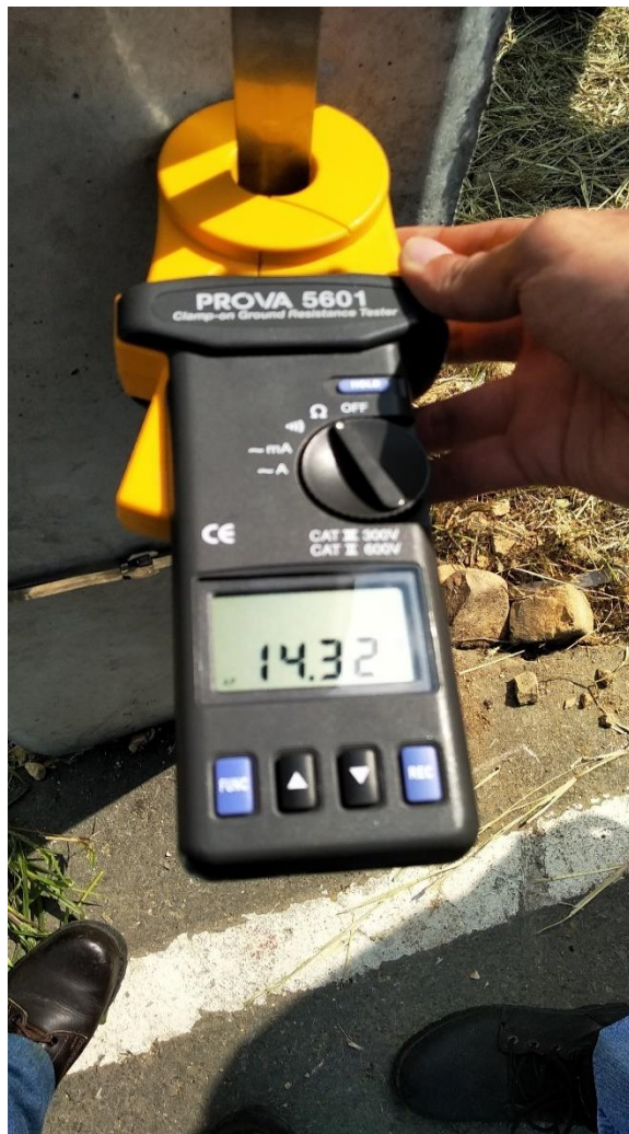
Imagen 18. Medida registrada el 1 de marzo del año 2019 en sistema de puesta a tierra de acero inoxidable instalado en Vía a la Costa en Guayaquil
