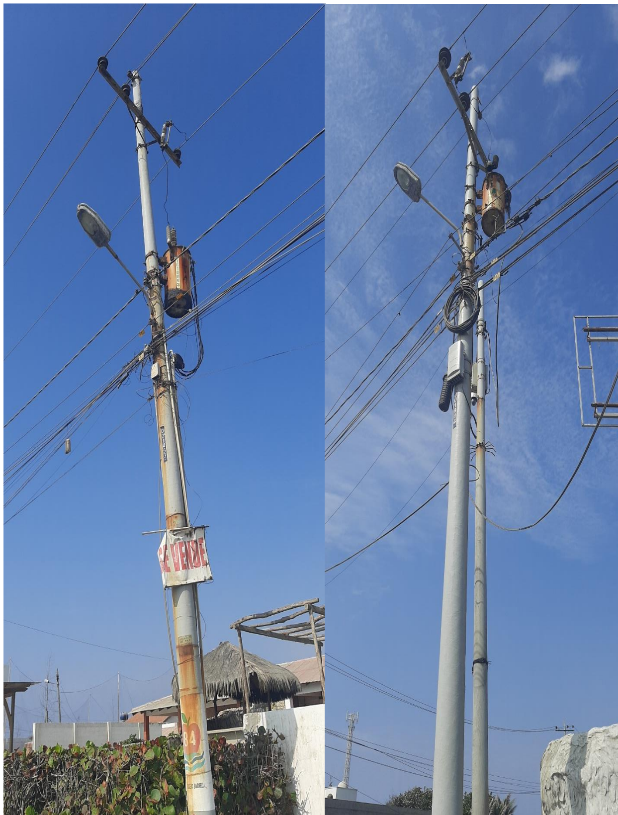
Imágenes de degradación de materiales eléctricos debido a alta salinidad en ambiente
