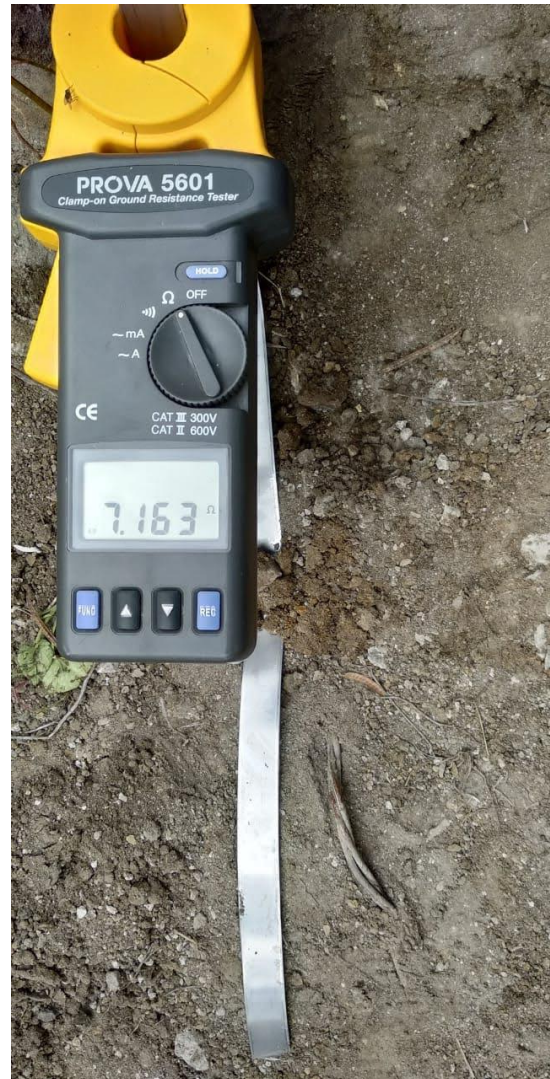
Imagen 17. Sistema de puesta a tierra en acero inoxidable para estructura en el POSTE 326 vía Salinas
