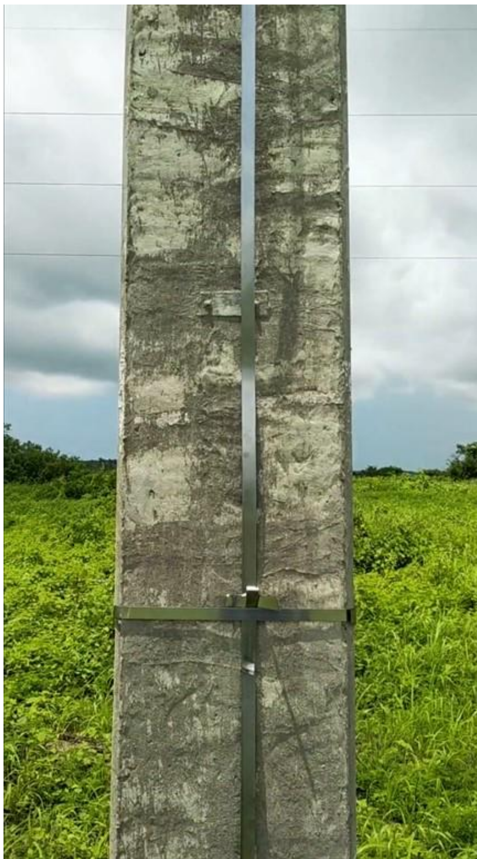
Instalación de SPT de acero inoxidable de estructura de transmisión vía Santa Elena, parte 2
