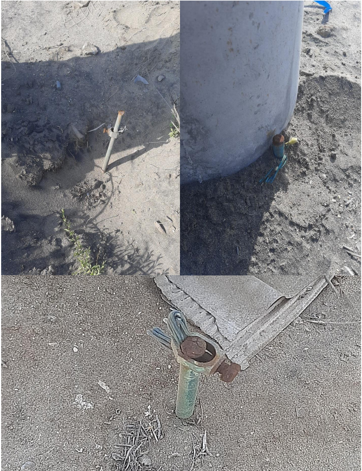
Imágenes de degradaciones en uniones de sistemas de aterramientos debido a par galvánico provocado por junta de metales diferentes
