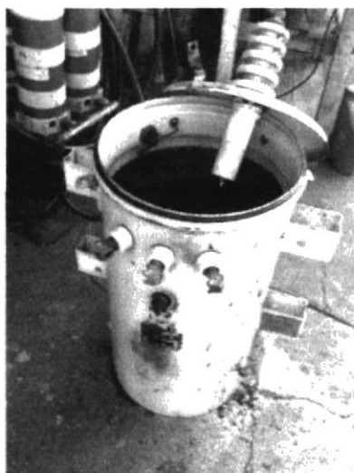
Fig. #26 Transformador de 25 KVA
