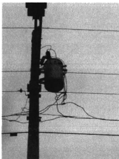
Fig. #27 Transformador de Poste
