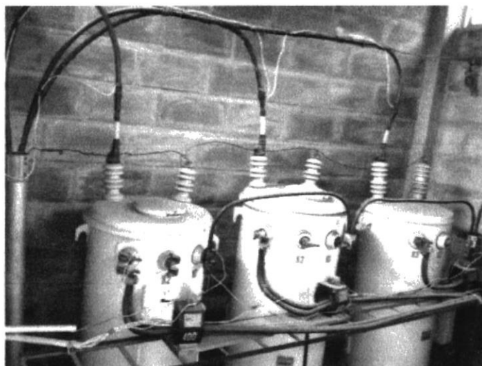
Fig. #25 Banco de Transformadores
