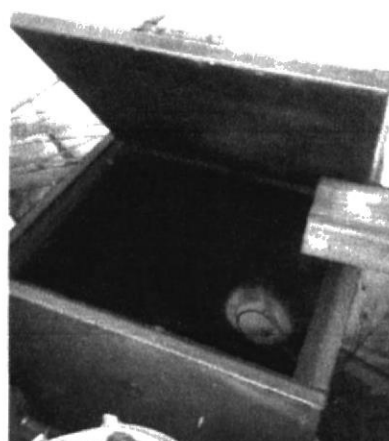
Fig. #32 Horno para sacar humedad del Transformador
