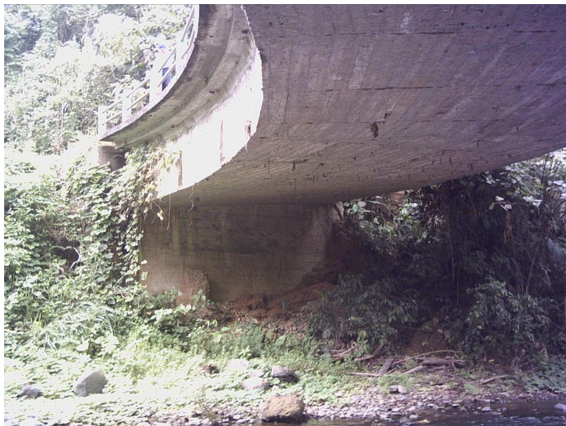
Vista inferior del puente con mucha vegetación (matorrales) y material transportado por el río aguas arriba.
