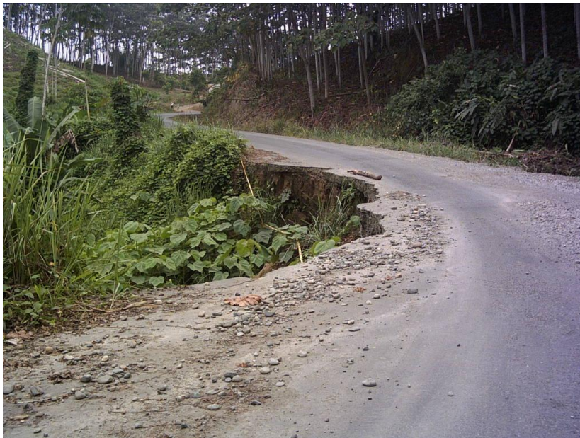
Vía de acceso al Puente, destruida como producto de la Erosión en el lugar.
