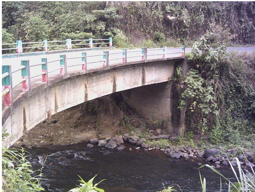
Situación actual del Puente Estrecho sobre el Río Peripa.
