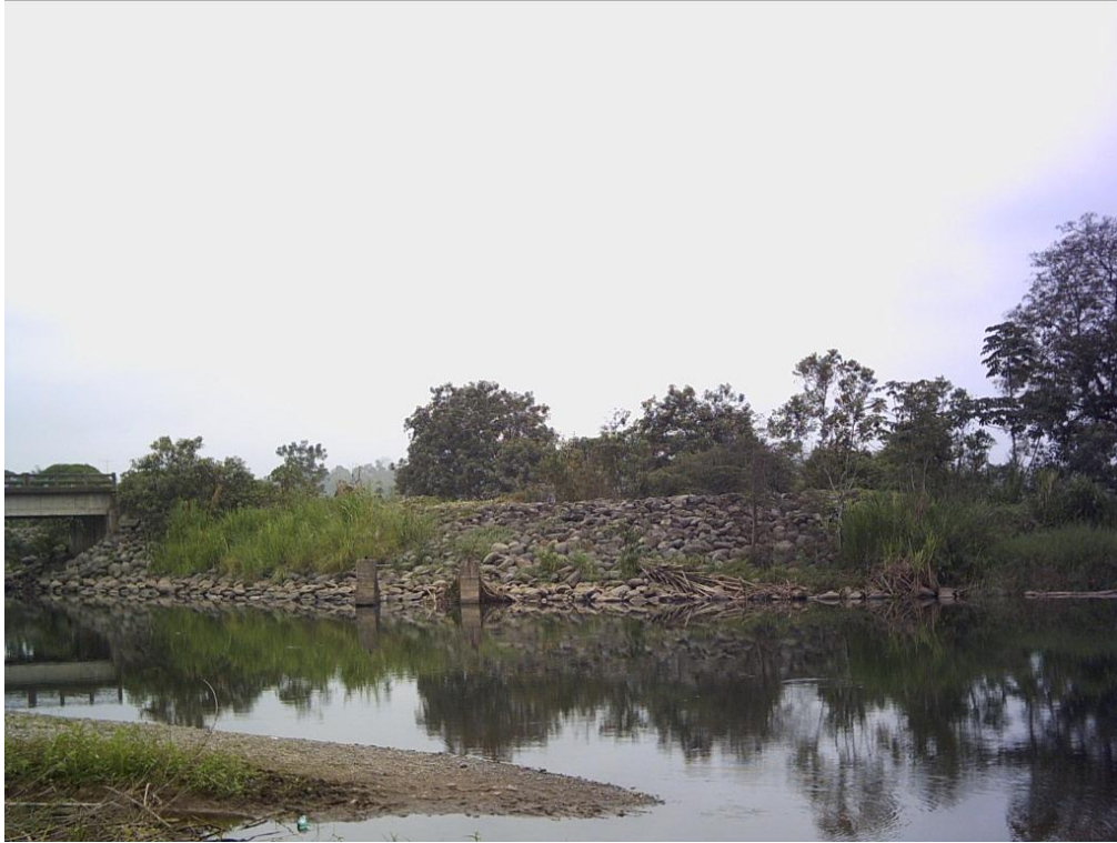
Pilas de un puente anterior que no soporto la Erosión.
