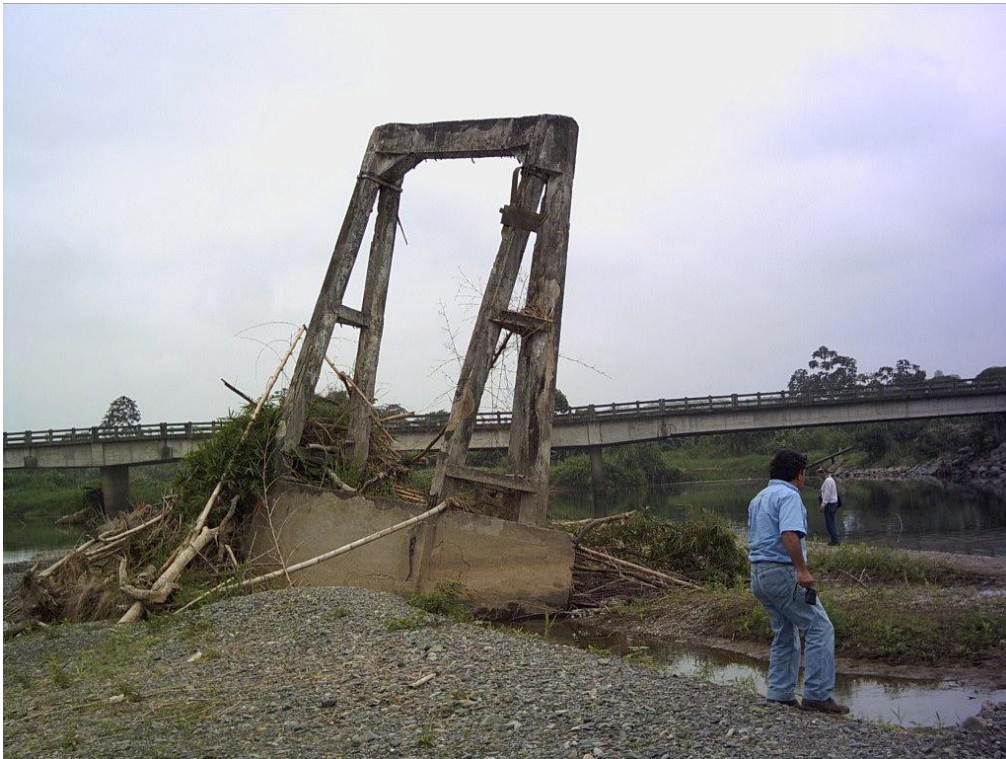
Pilas de un antiguo Puente derrumbado como producto de la Erosión.
