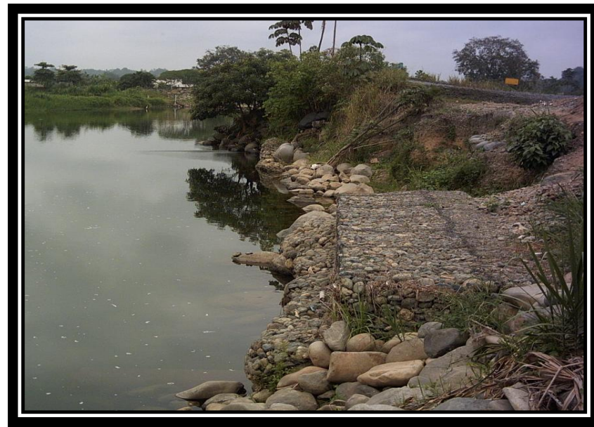
Pérdida de material sólido superficial
