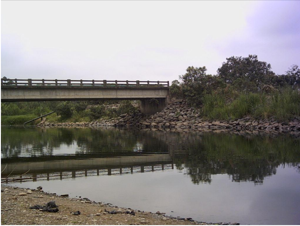
Grandes rocas ubicadas el las Pilas del Puente para controlar un poco la Erosión.
