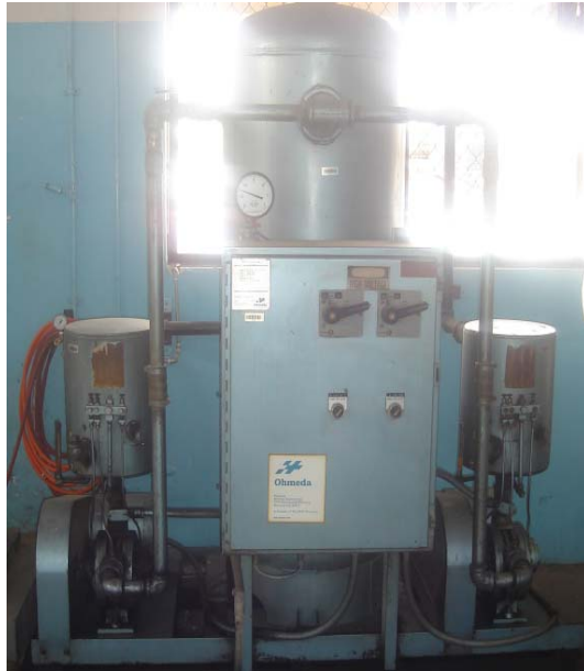
Fig. 5.14 Compresor de vacío
