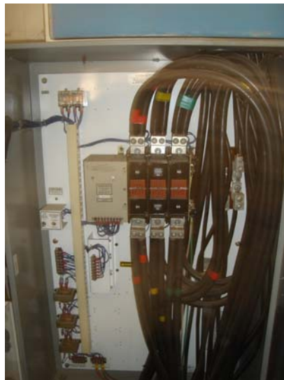
Fig. 1.20 Tablero de maniobras del hospital de SOLCA
