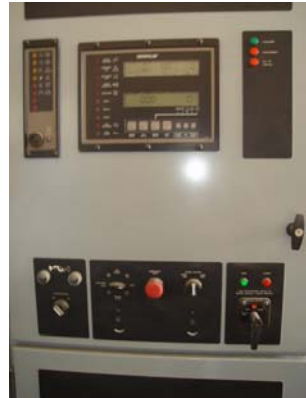
Fig. 1.16 Tablero de paralelismo de generadores G1 y G2 del hospital de SOLCA
