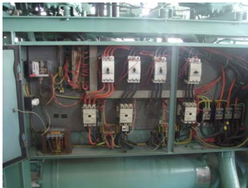
Fig. 6.1 Tablero de compresores de equipos chiller en área de acondicionadores de aire
