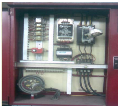
Fig. 6.3 Tablero de bombas contra incendio
