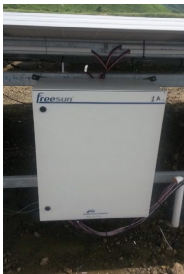
Figura. 3.30 Cableado de mesas a string box
