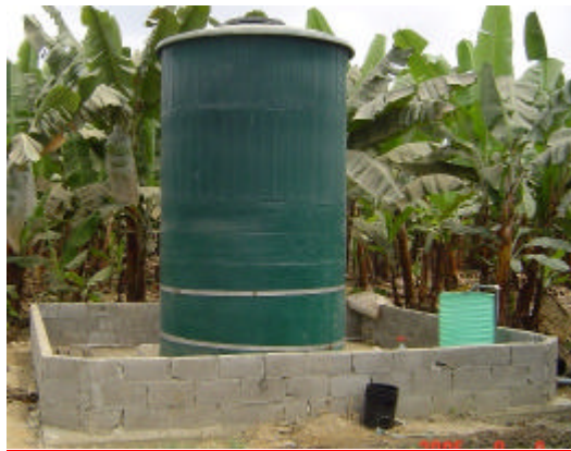
FIGURA 4.17 TANQUE DE TRILEX
