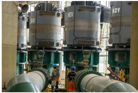
Figura 7: Grupos de bombeo de captación de agua cruda
