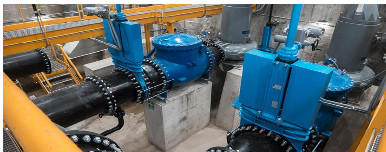
Figura 11: Infraestructura de estación de agua servida y lluvia
