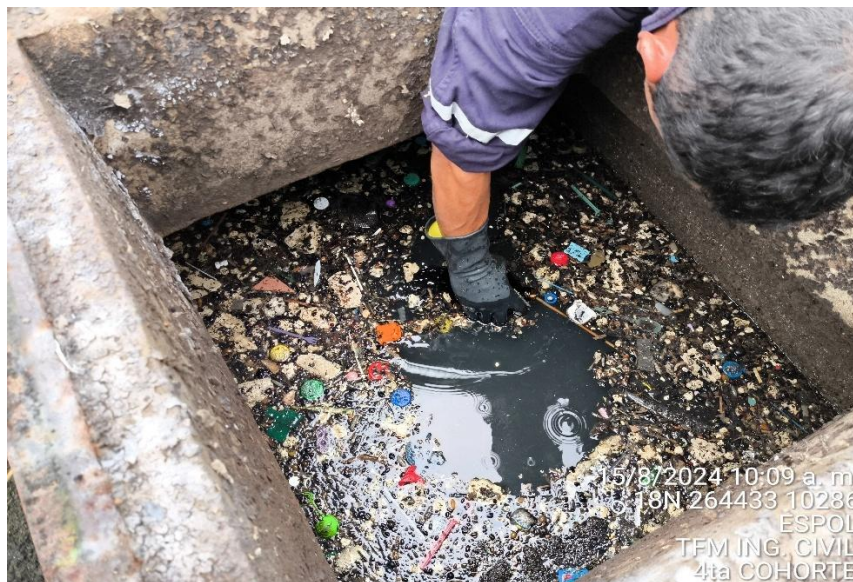
Figura 9. Fotografía fosa séptica con presencia de residuos no degradables.
