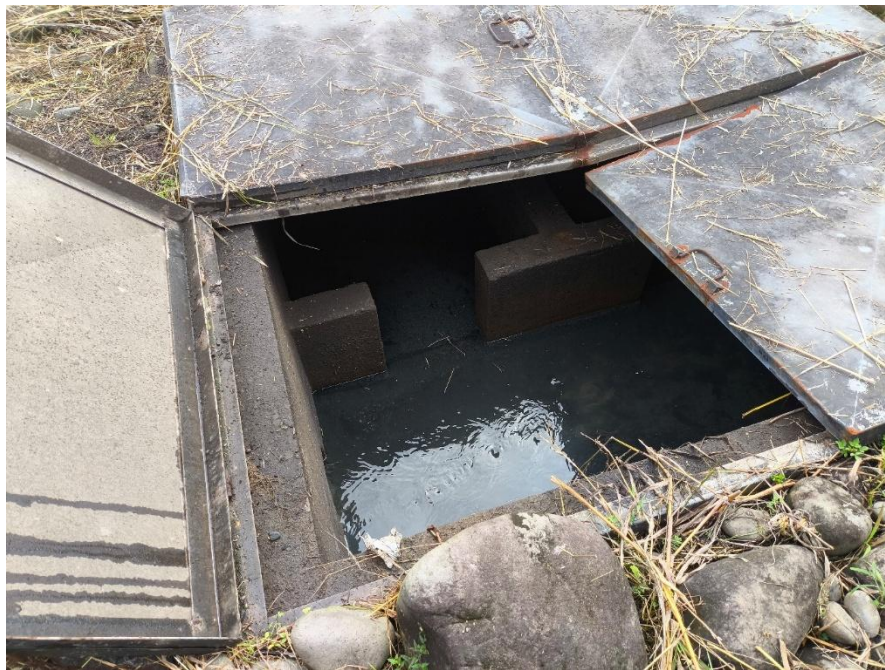
Figura 9. Fotografía de tapa del separador de caudales deformada y bisagras rotas.
