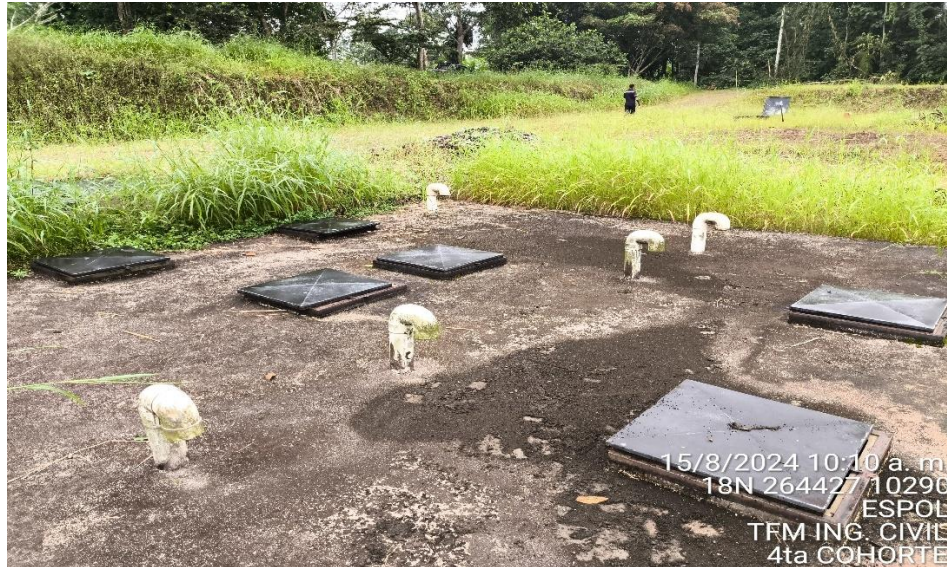
Figura 10. Fotografía fosa séptica tapas en mal estado.
