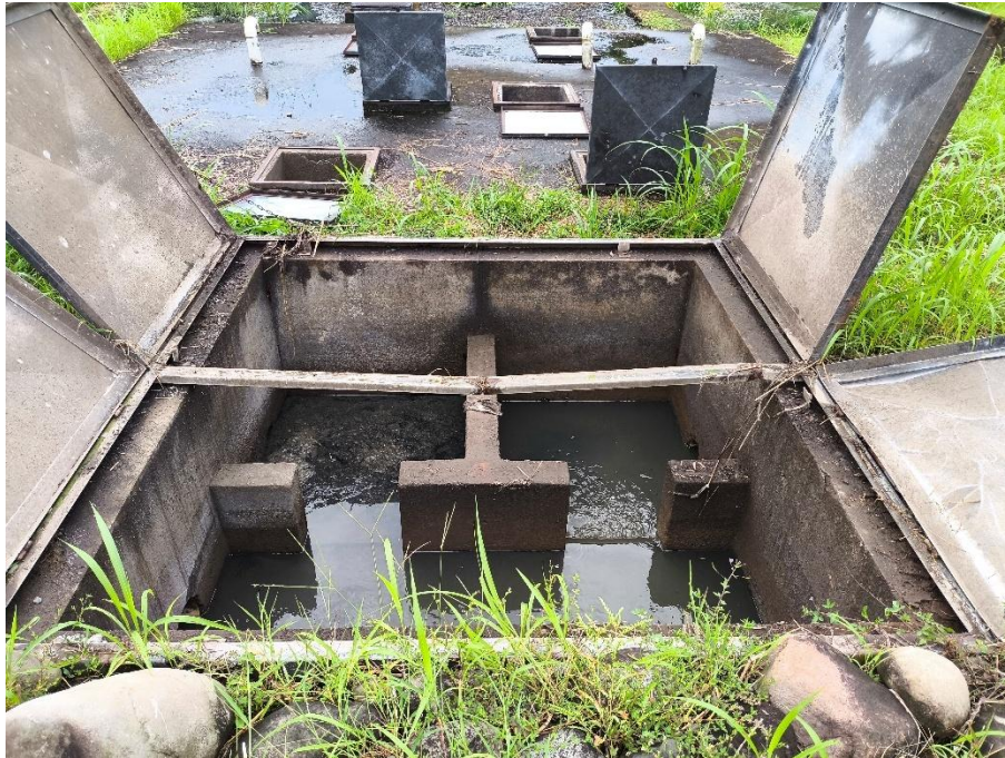
Figura 10. Fotografía del separador de caudales con material sedimentario en el canal izquierdo.
