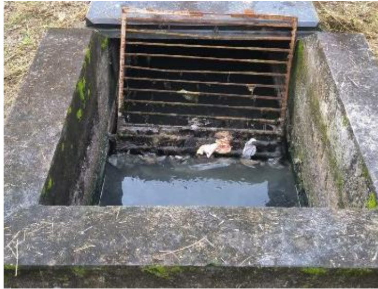
Figura 7. Fotografía de cribas en estado de oxidación .
