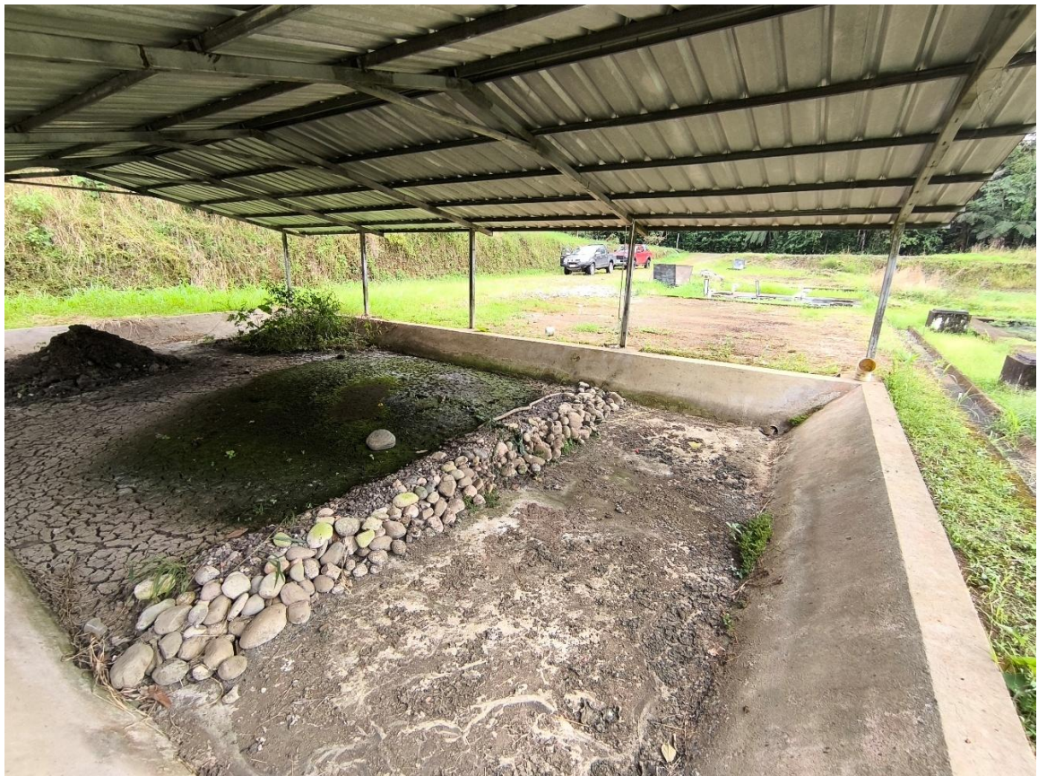
Figura 14. Fotografía de lecho de secado de lodos.
