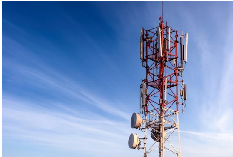
Figura 1.1 Torre Auto soportada con equipos de Telecomunicaciones
