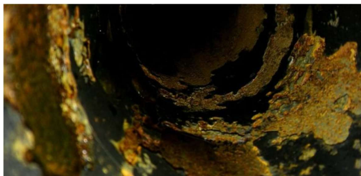
Ilustración 10 Corrosión de acero (Concepto, s.f.)
