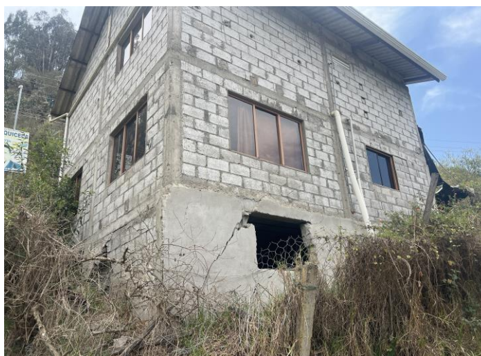
Figura 2 Casa afectada en Zumbahuayco
