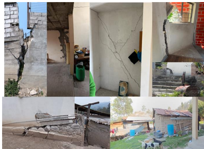
Figura 17 Cuarteo en la estructura de viviendas
