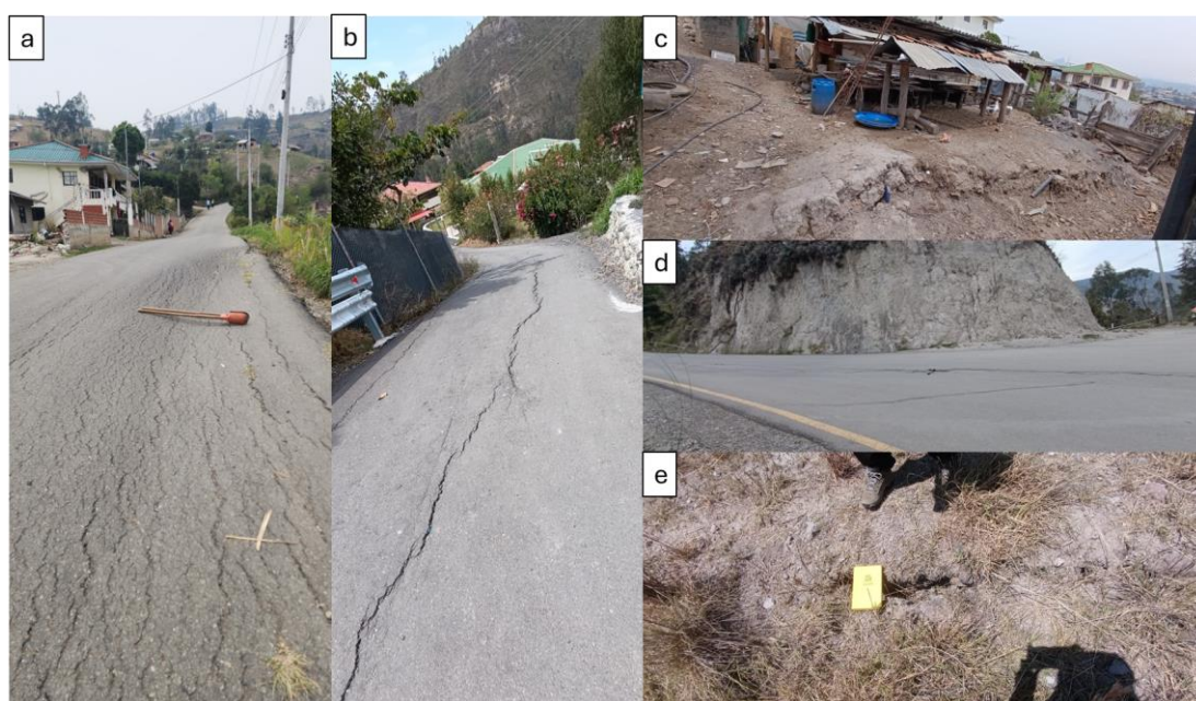
Figura 27 Grietas y escarpes en la comunidad
