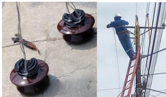
Figura 3.1 Pernos tipo Pin en una estructura o cruceta Fuente y elaboración propia
