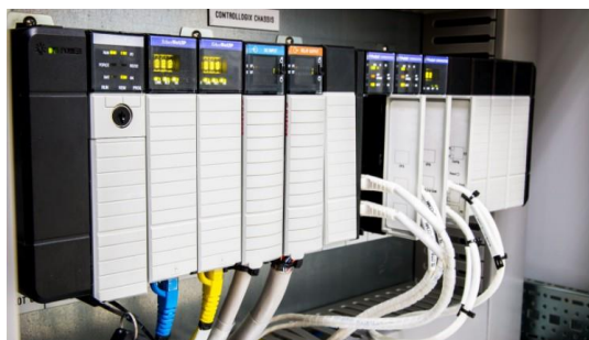
Figura 1.5 Estación de entrenamiento con PLC (serie ControlLogix 5500) de la marca Rockwell Automation
